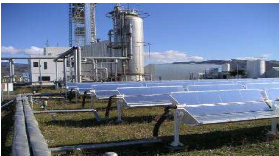
Figura 2: Campo de colectores ACUREX (cortesía de la PSA)
