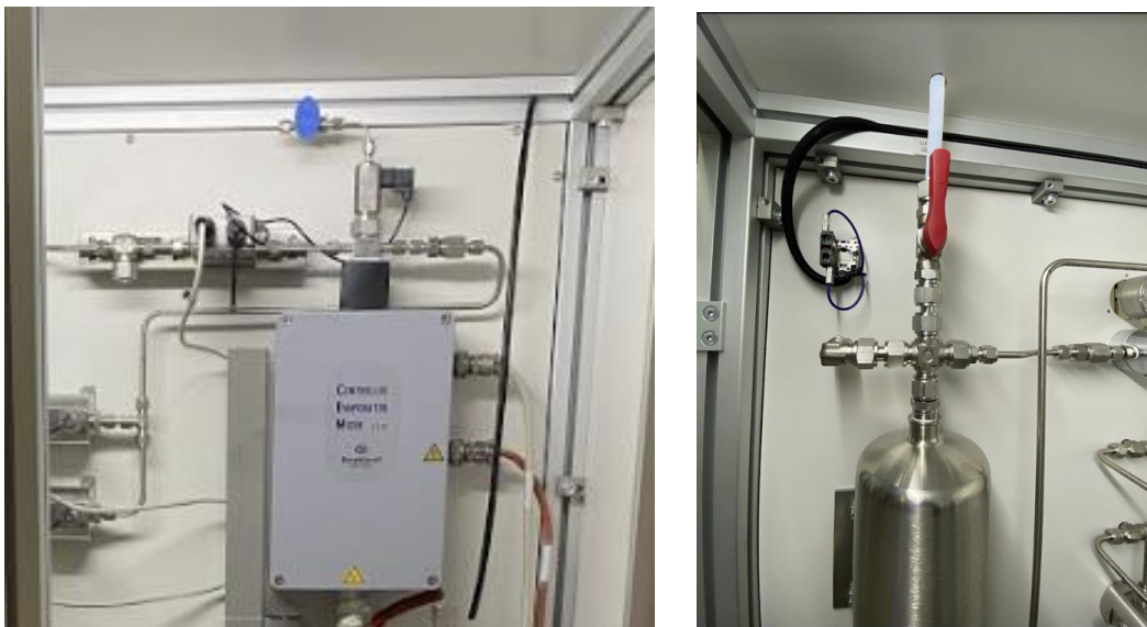
Figura 6. Línea de agua y vaporizador de la instalación (izquierda), depósito de agua (derecha)
