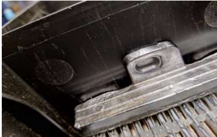
Figura 26. Desalineación de la soldadura debido a la mala colocación de las uniones (Fuente: Elaboración propia).
