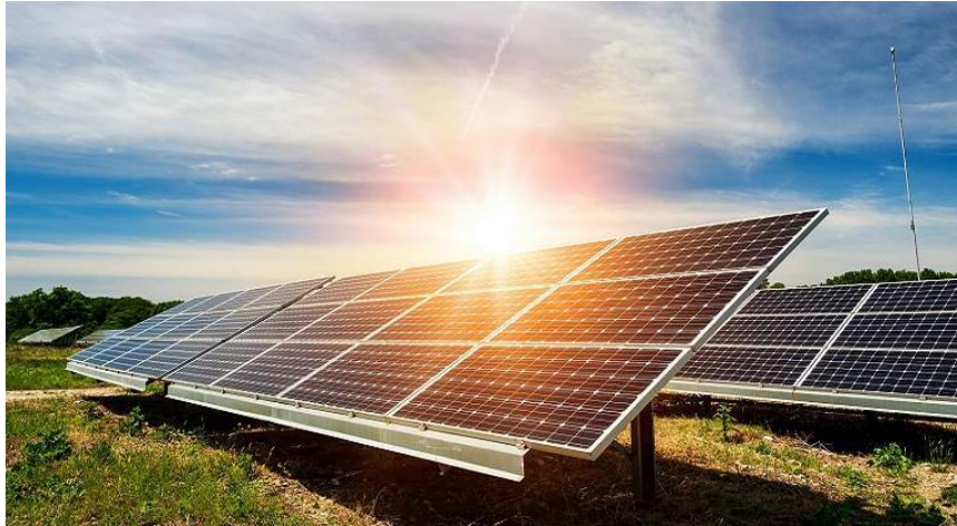
Figura 8. Instalación solar fotovoltaica (Fuente: Eleconomista.es)
