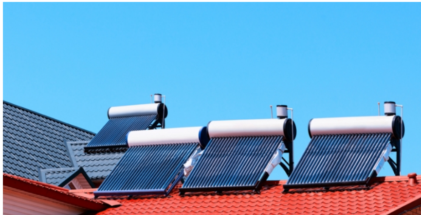
Figura 7. Instalación termosolar de uso doméstico (Fuente: Tecpa.es)
