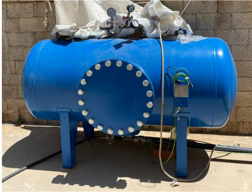
Figura 4.13. Calderín presente en la instalación
