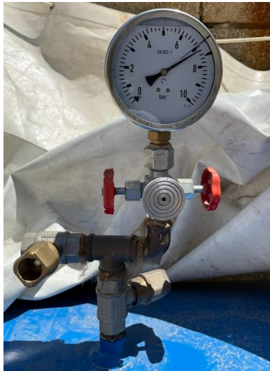
Figura 4.14. Manómetro para medir la presión adentro del calderín.
