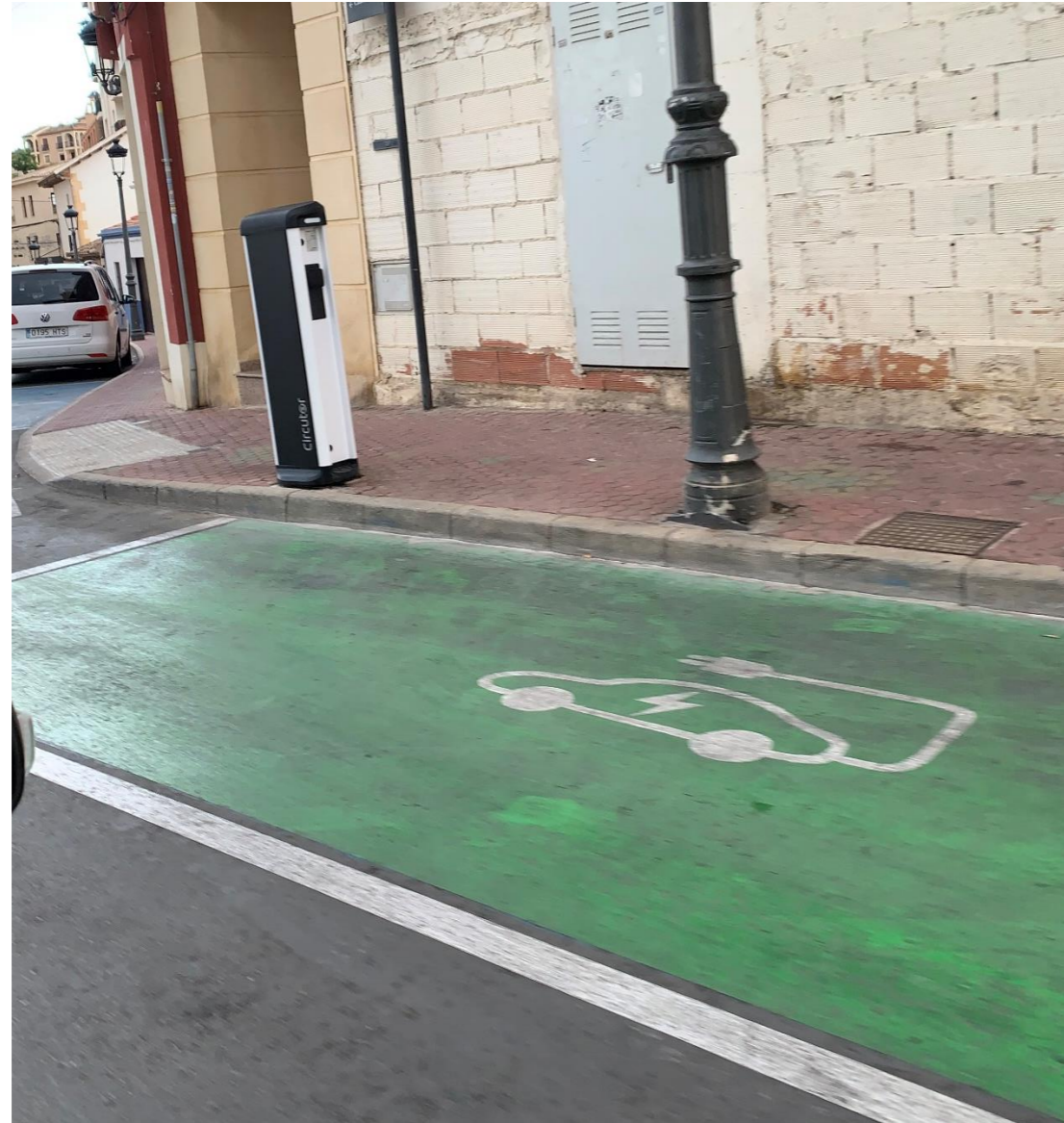
Imagen 18: Punto de recarga eléctrica. Fuente: Elaboración propia.
