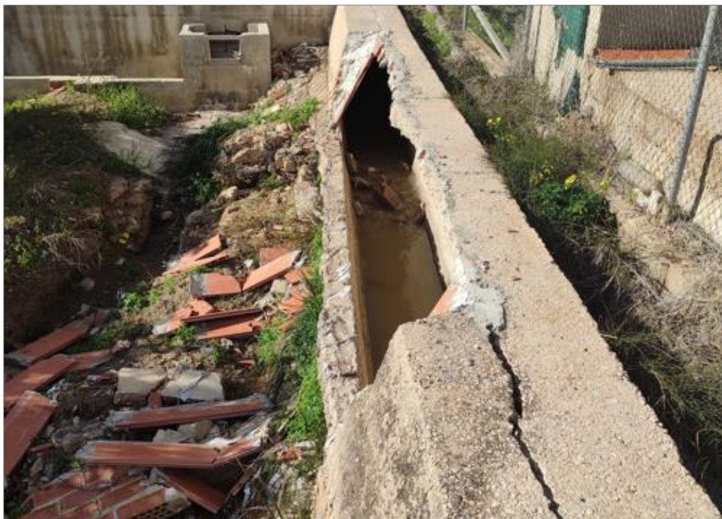
Foto 5 Rotura de colector durante episodios de gota fría. La Pobla Llarga
