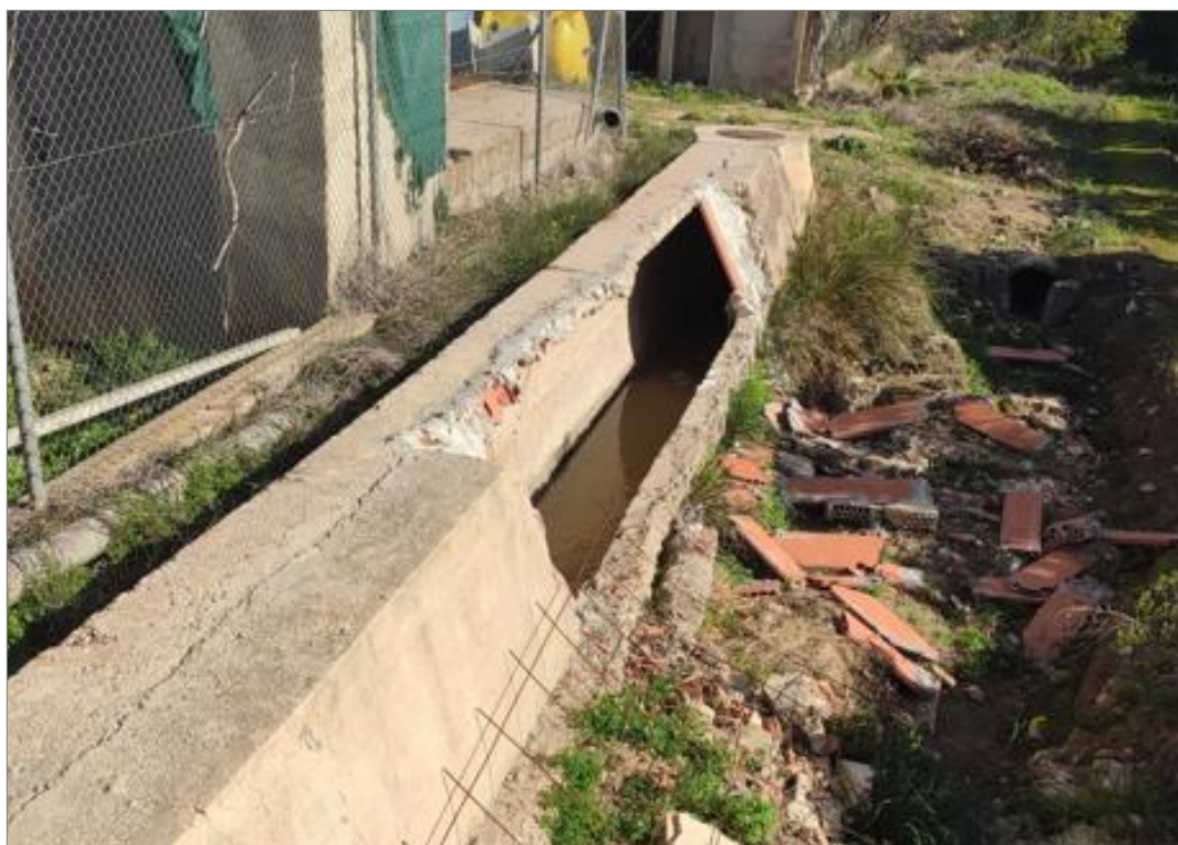
Foto 6 Foto 5 Rotura de colector durante episodios de gota fría. La Pobla Llarga
