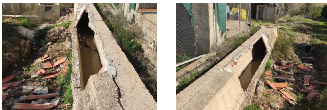
Foto 3. Colector dañado tras su entrada en carga durante episodio de gota fría el pasado 2020
