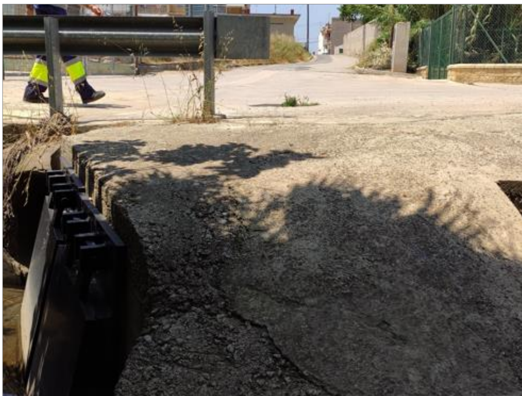
Foto 8 Punto de desagüe de pluviales en el cauce del barranco de Barxeta. Red alcantarillado La Pobla Llarga
