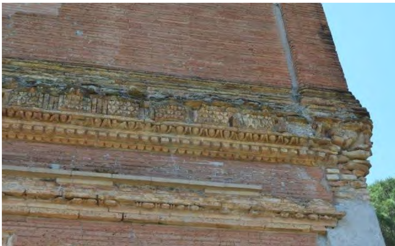
Fig. 41 - Tomba dei Barberini : detalle de la fachada de ladrillo y decoraciones. Incluso dañados, estos últimos presentan una gran definición en los detalles. (Fuente: Autor).
