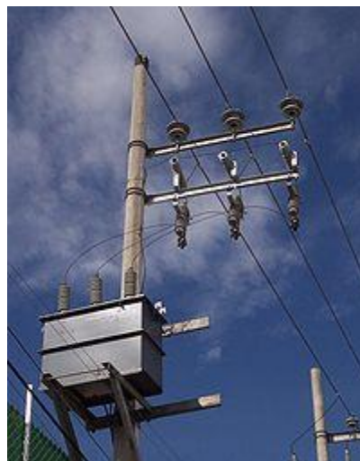
Ilustración 6: Centro de transformación 5
