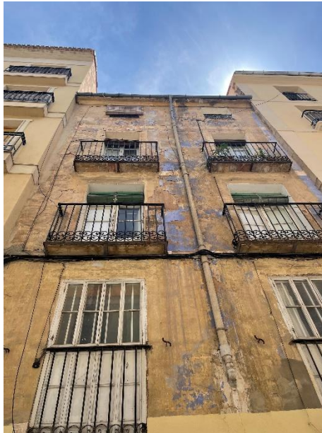
Il·lustració 4 Edificio en estado de conservación deficiente, C. Sant Josep. Fotografía de autoría propia
