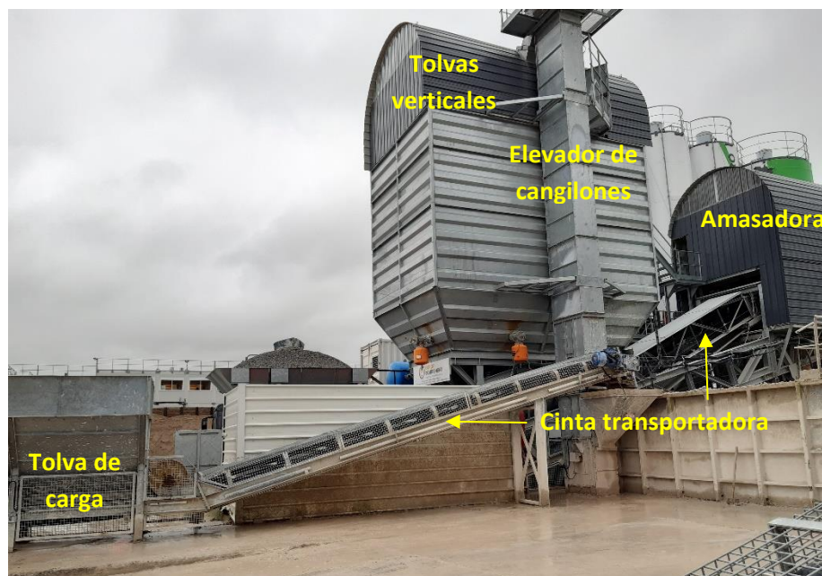
Ilustración 9. Esquema de las partes de una central de hormigón. Fuente: Elaboración propia.
