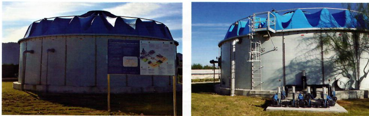
FIGURA 3. Tanque de almacenamiento adicional (depósito de elutriación).
