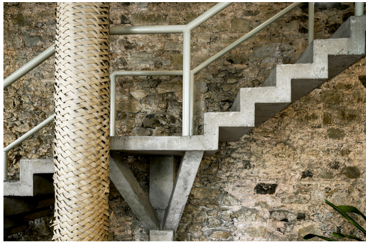
fig. 88: Escalera nueva entre muro de piedra y pilar. Centro cultural Casa do Benin.
