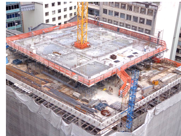
Ilustración 222 - Forjado de la estructura de la piscina donde se ve el acero de espera para construcción de las vigas de la piscina. (Fuente: MMBB Arquitectos).
