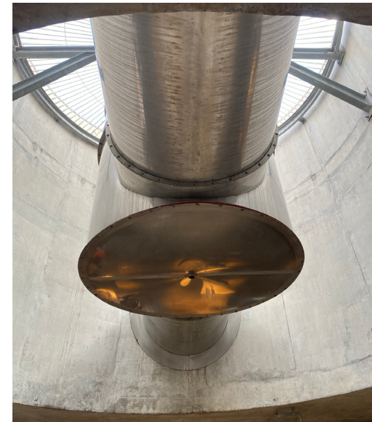
Ilustración 237 - Sistema de extracción de humo en el hueco de la piscina. (Autoría propia, 2021).
