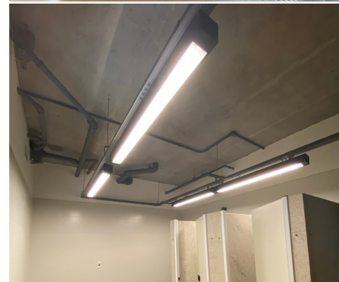
Ilustración 231 - Instalaciones eléctrica e hidráulica vistas. (Autoría própria, 2021).
