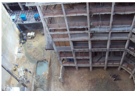
Ilustración 107 - Fotografía al termino de las demoliciones. Lucernario, cerramientos y edificio anexo demolidos. (Fuente: MMBB Arquitectos).
