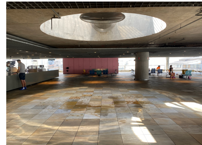
Ilustración 115 - Hueco del bloque de la piscina con el suelo mojado con el agua de piscina. (Autoría propia, 2021).
