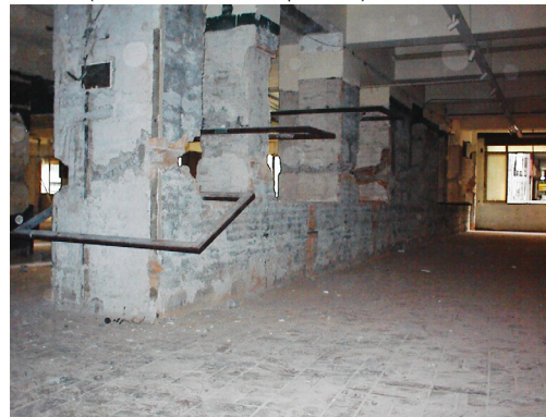
Ilustración 63 - Planta segunda de la tienda Mesbla en el encuentro del edificio original y el edificio anexo. (Fuente: MMBB Arquitectos).
