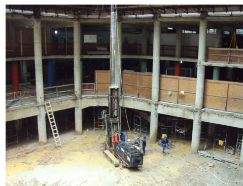
Ilustración 108 - Fotografía al termino de las demoliciones en el vacío central. (Fuente: MMBB Arquitectos).
