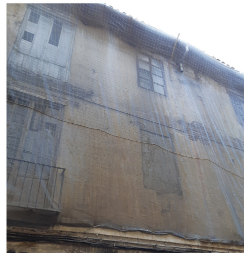
2 Avanzado estado de degradación
