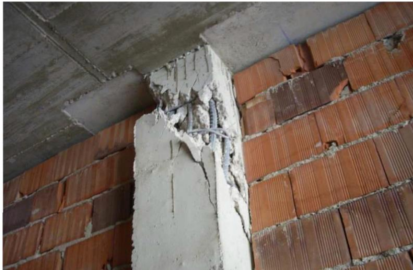
Figura 1-3: Daños en cabeza de pilar debido a la tabiquería
