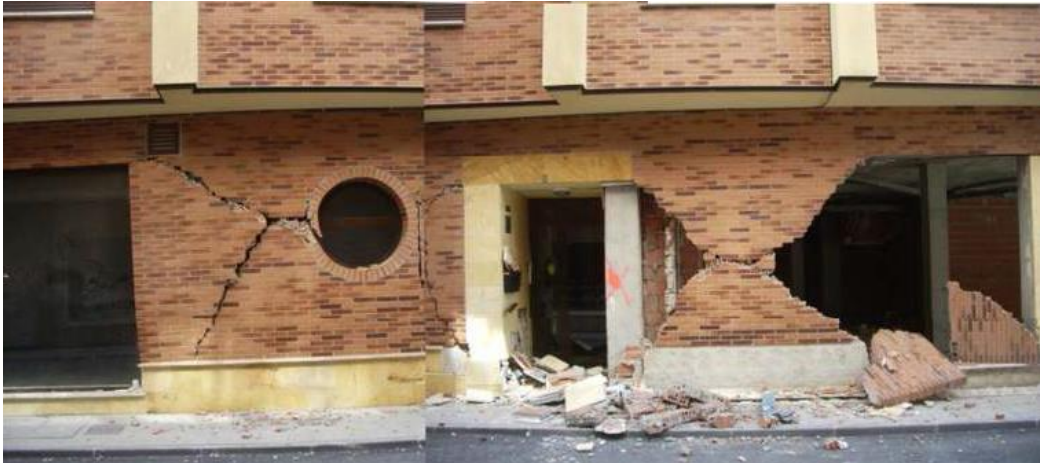
Figura 1-2: Daños ocasionados durante el terremoto de Lorca en 2011.
