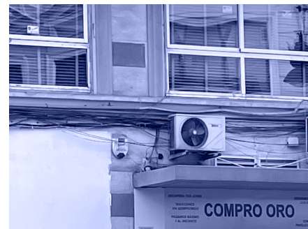
Gran cantidad de cables de comunicación dispuestos sin orden
