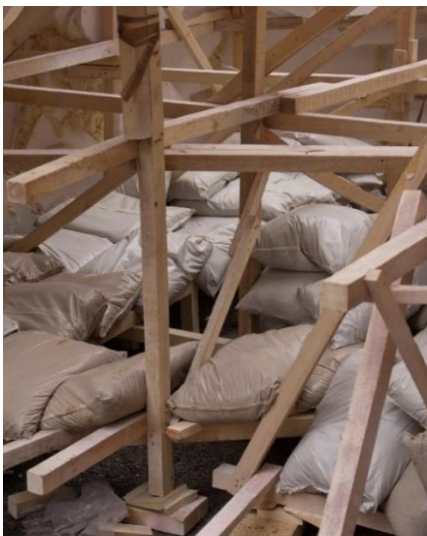
Fig. 34 Sacos de arena sujetando el caballete de la falla.
