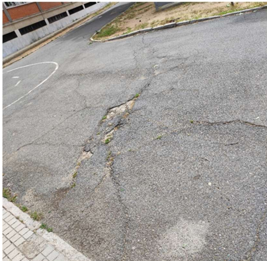
Figura 7: Boquete en el suelo del patio (junio 2022)
