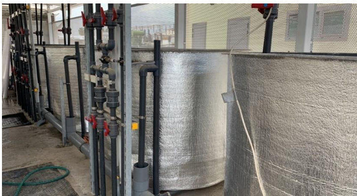
Figura 3. Detalle del material aislante para cada tanque, junto al sistema de tuberías individual de cada uno.
