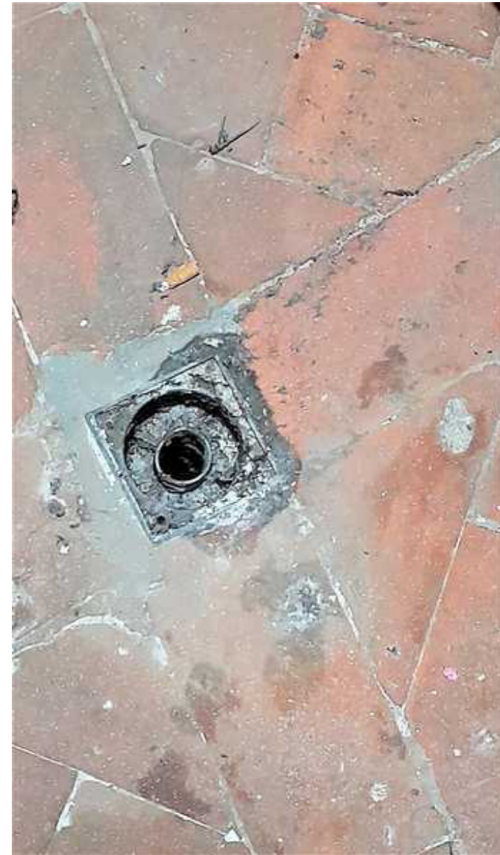
Evacuación de aguas. Sumideros. [Ref. IN002]
