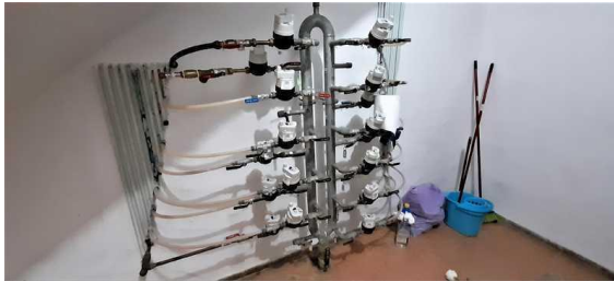
Ilustración 25. Contadores de agua.
