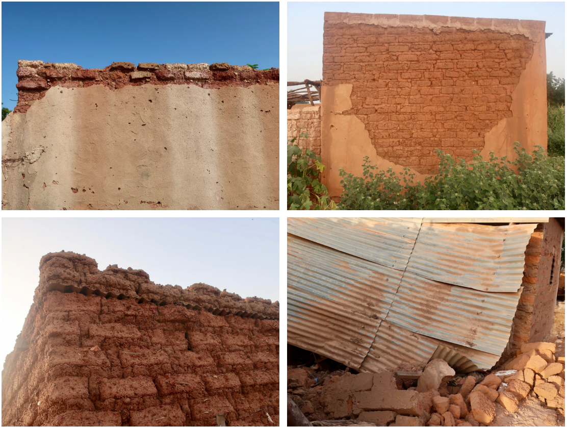
Fig.2.50. Fallos y problemas de conservación comunes en la coronación y en la base del muro, agravados por la combinación de la tierra con mortero de cemento o de una ejecución inadecuada de la cubierta de chapa metálica.
