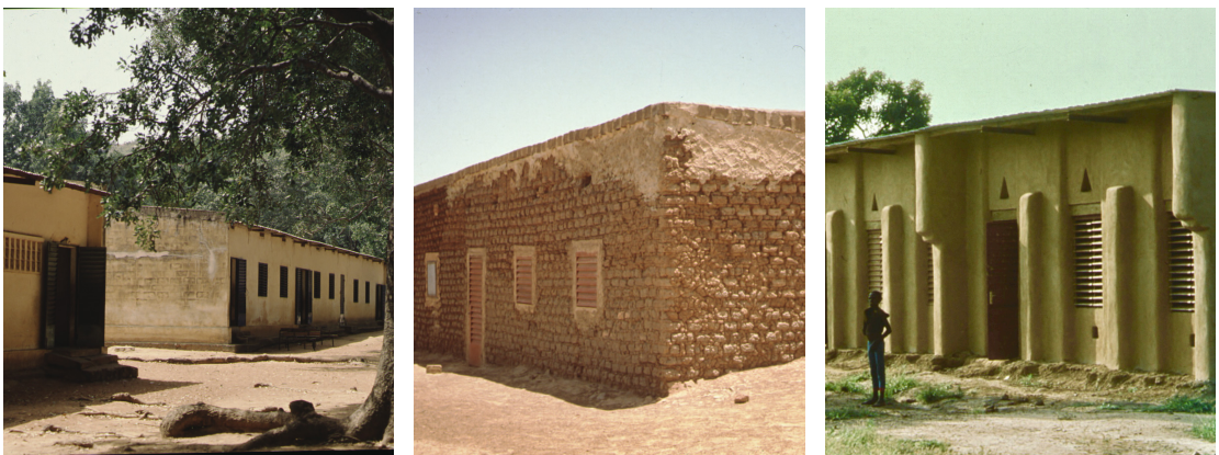
Fig. 3.10. Construcciones modernas de escuela en Tiébélé con bloque y mortero de cemento y cubierta de chapa; construcciones realizadas por la población para ser utilizadas como escuelas en Naongane, con adobe, cubierta de chapa metálica y reparaciones de mortero y bloque de cemento; prototipo de escuela propuesto por el proyecto en Yagma, con adobe revestido con mortero de tierra y cubierta de chapa. Fuente: CRAterre.
