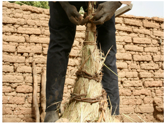
Fig.2.39. Proceso de construcción de una cubierta. Fuente de la segunda imagen: Xavi Ferragud.
