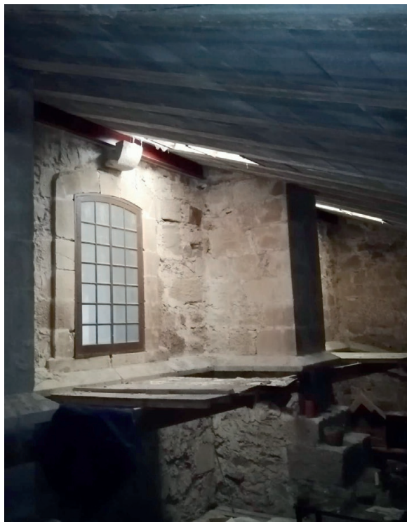
Figura 8. Estado actual de los huecos de los lunetos del lado norte de la iglesia bajo el forjado colocado en 1991.
