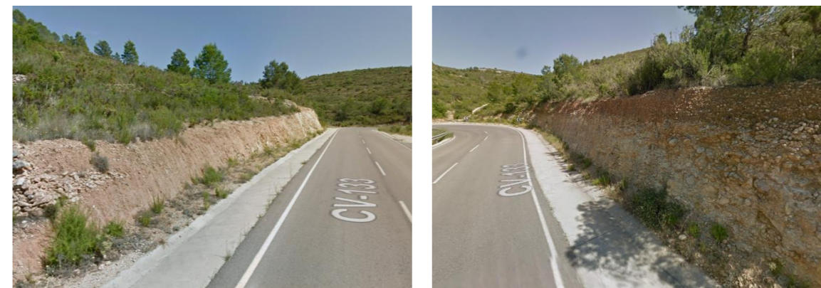
Ilustración 1. Taludes existentes sobre arcillas rojas, conglomerados y areniscas de la Zona 4 (Fuente: Google)
