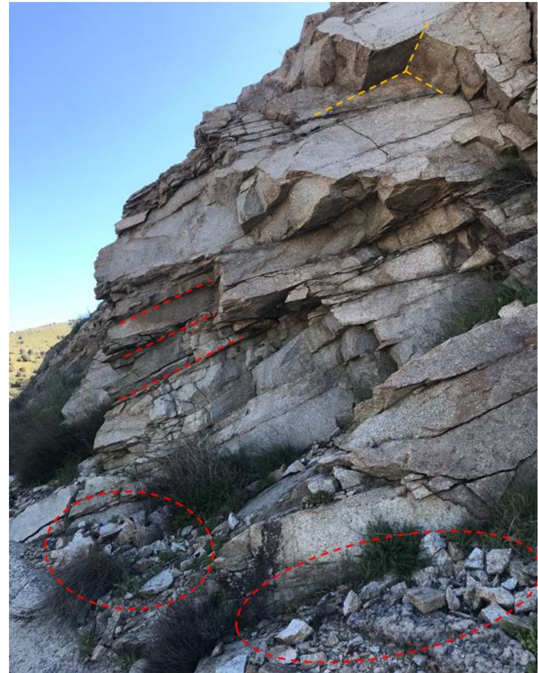
Figura 17 – Chineos en pie de talud. Buzamiento a vía. Familias de discontinuidades que favorecen la formación de bloques con deslizamiento a vía. Fuente: Propia.
