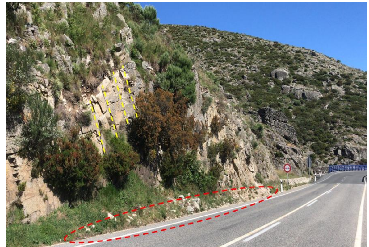
Figura 28 – Ausencia de cuneta en pie de talud. Familia de discontinuidades. Abundante vegetación en talud. Fuente: Propia.
