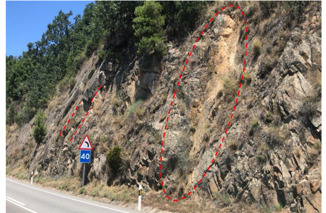
Figura 39 – Zona de reguero de agua. Planos de rotura. Fuente: Propia.
