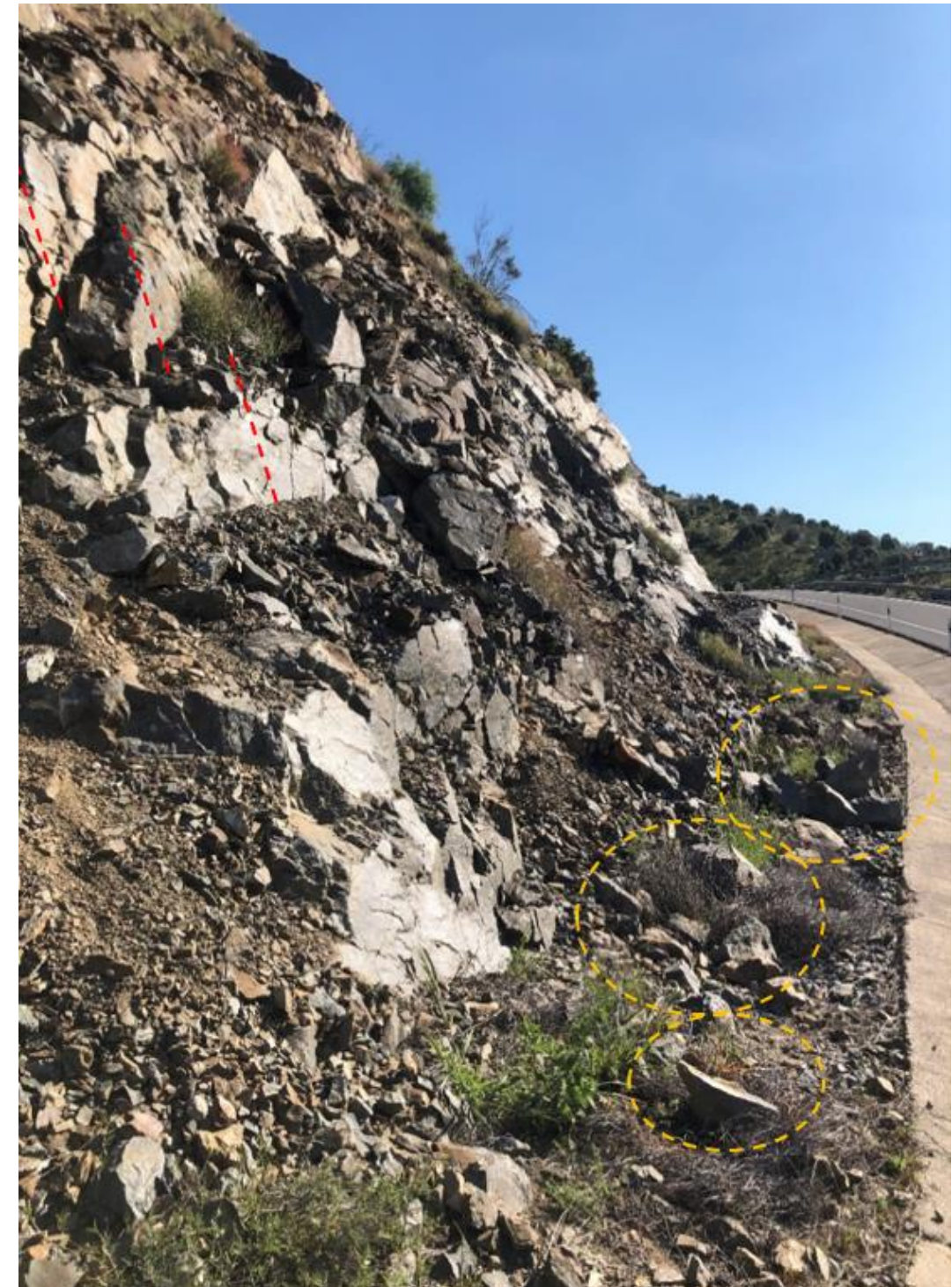
Figura 3 – Familia de discontinuidades. Bloques en pie de talud. Chineos y meteorización. Fuente: Propia.
