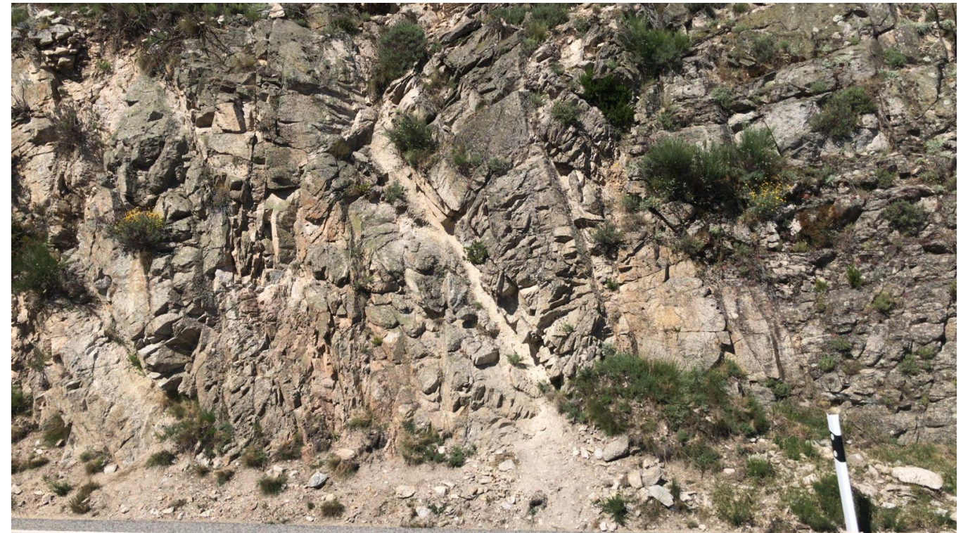
Figura 25 - Detalle de zona de escorrentía en talud 9. Fuente: Elaboración propia.
