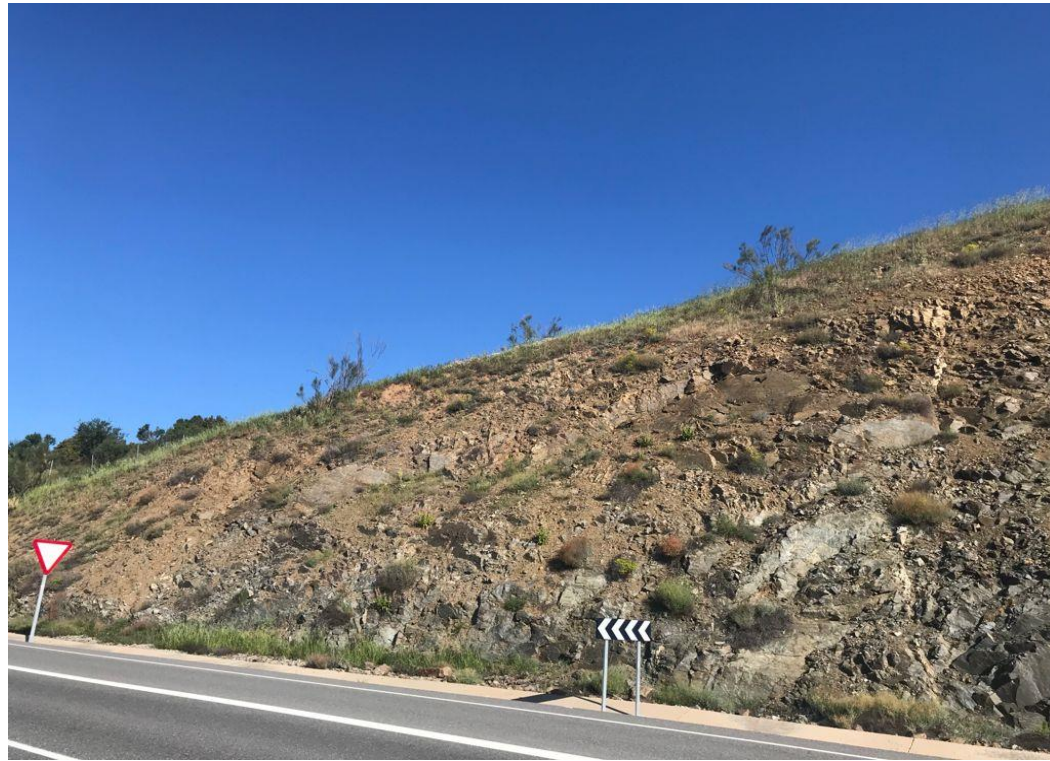
Figura 2 - Desprendimientos en talud 1. Fuente: elaboración propia.
