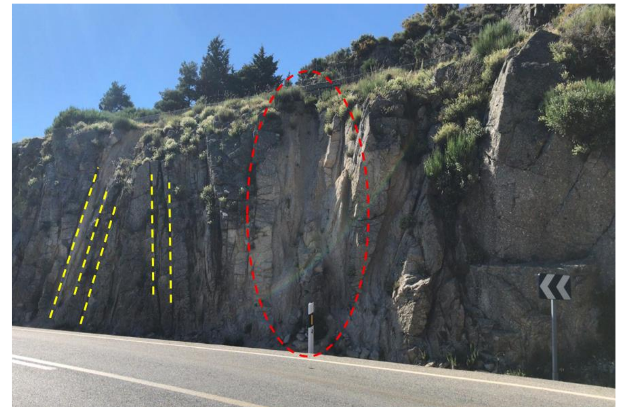
Figura 25 – Zona de reguero de agua. Discontinuidades. Fuente: Propia.
