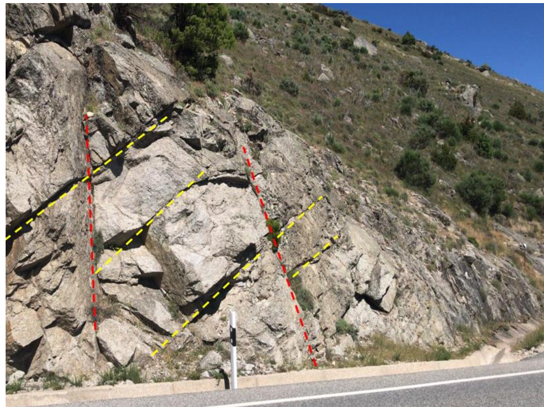
Figura 31 – Familias de discontinuidades que favorecen caída de bloques a vía. Fuente: Propia.
