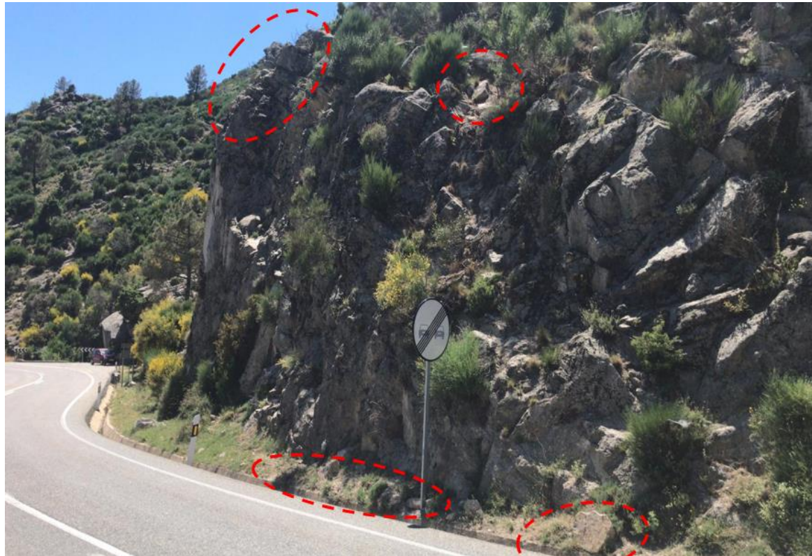
Figura 35 – Bloques inestables en cabeza de talud. Presencia de bloque caído en pie de talud. Cuneta de tamaño reducido. Talud en curva. Fuente: Propia.
