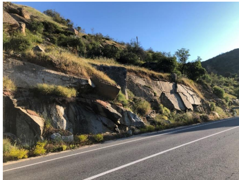
Figura 10 - Detalle roturas en talud 3. Fuente: Elaboración propia.
