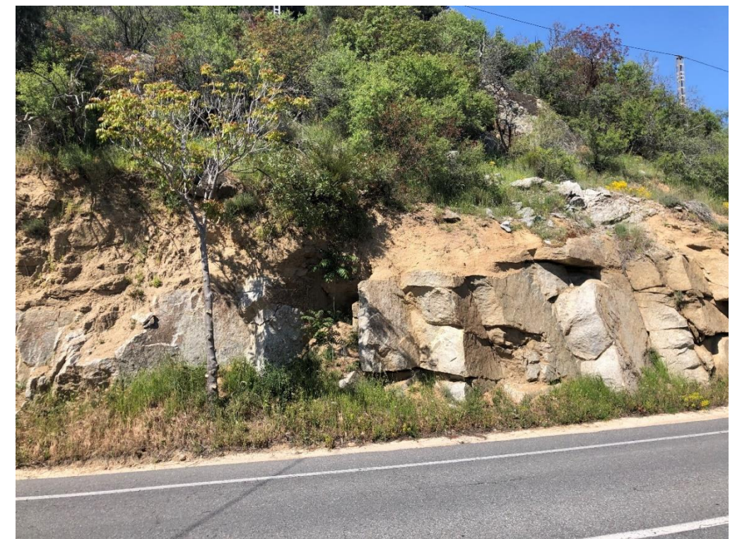
Figura 12 - Detalle de árbol en cuneta en talud 4. Fuente: Elaboración propia.
