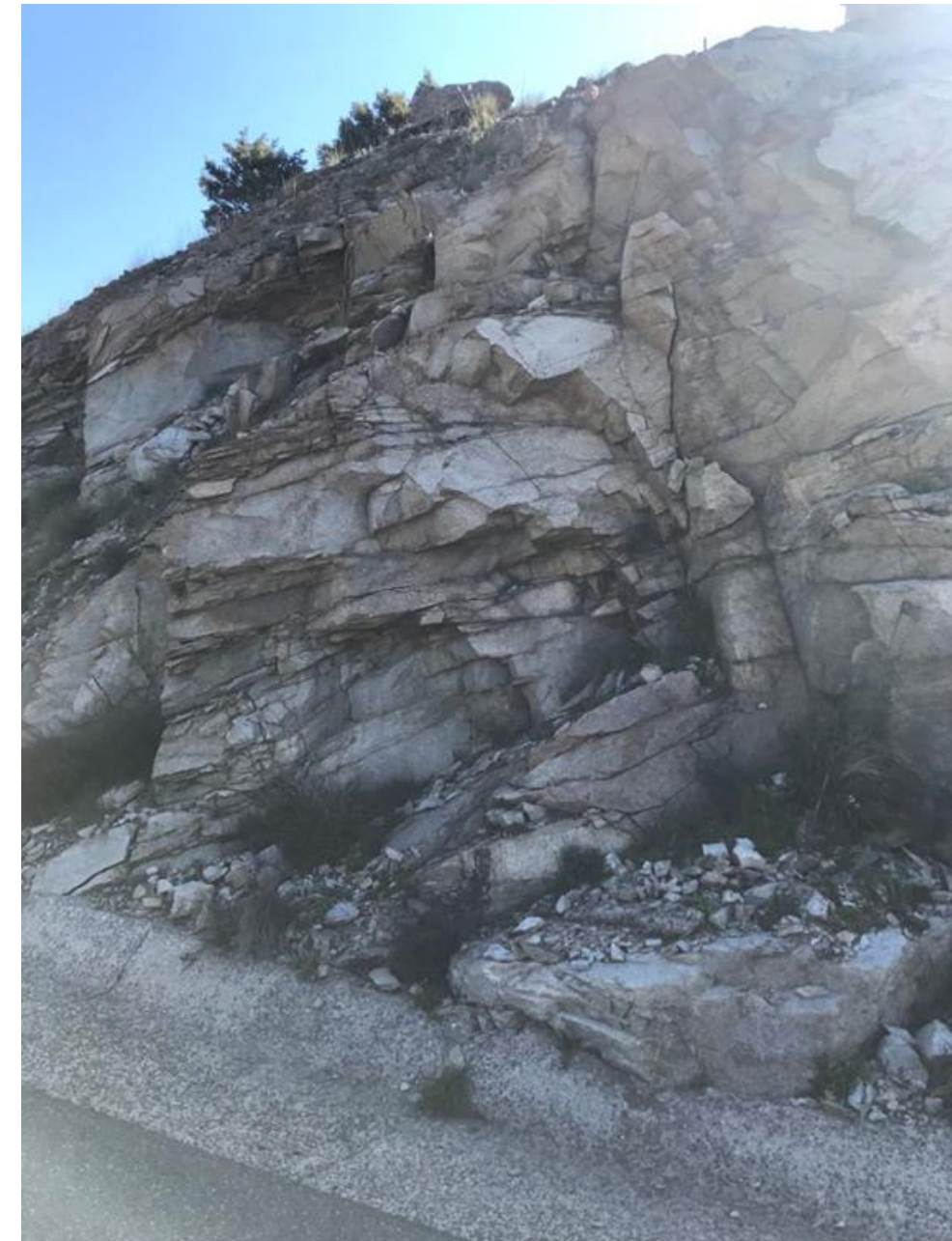
Figura 17 - Detalle de estratificación en talud 6. Fuente: Elaboración propia.
