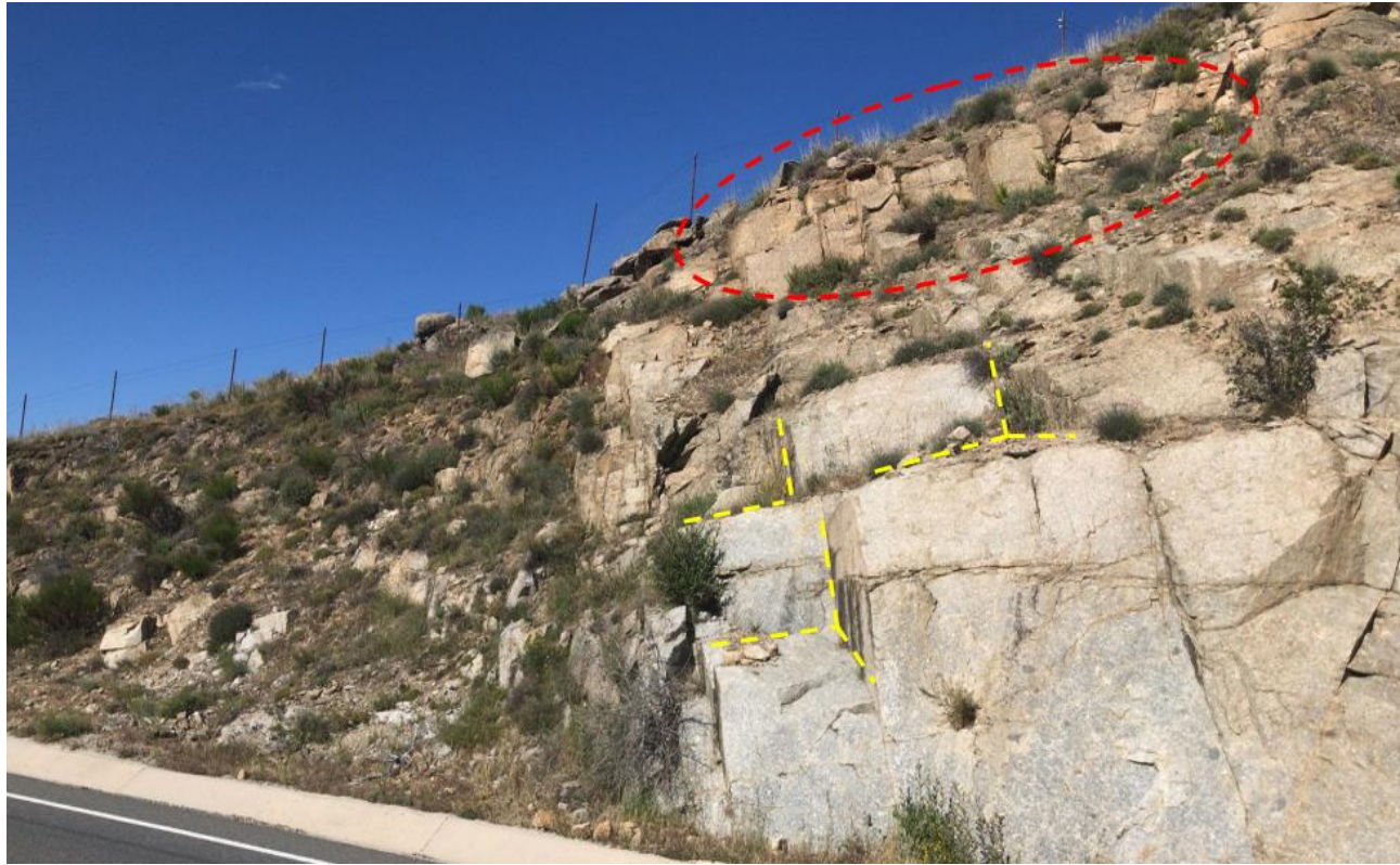
Figura 18 – Familias de discontinuidades principales. Bloques inestables en cabeza de talud. Fuente: Propia.
