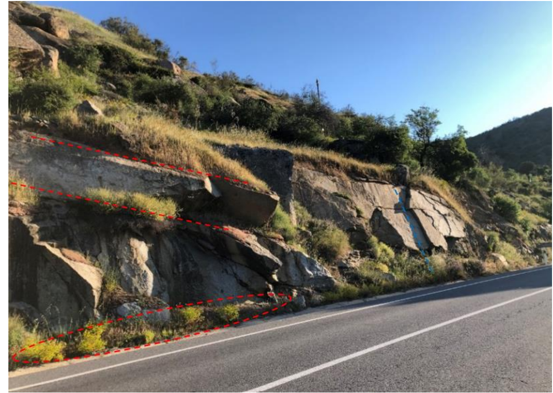
Figura 9 – Dos familias de roturas planares con buzamiento hacia vía. Berma en pie de talud de tamaño reducido. Fuente: propia.
