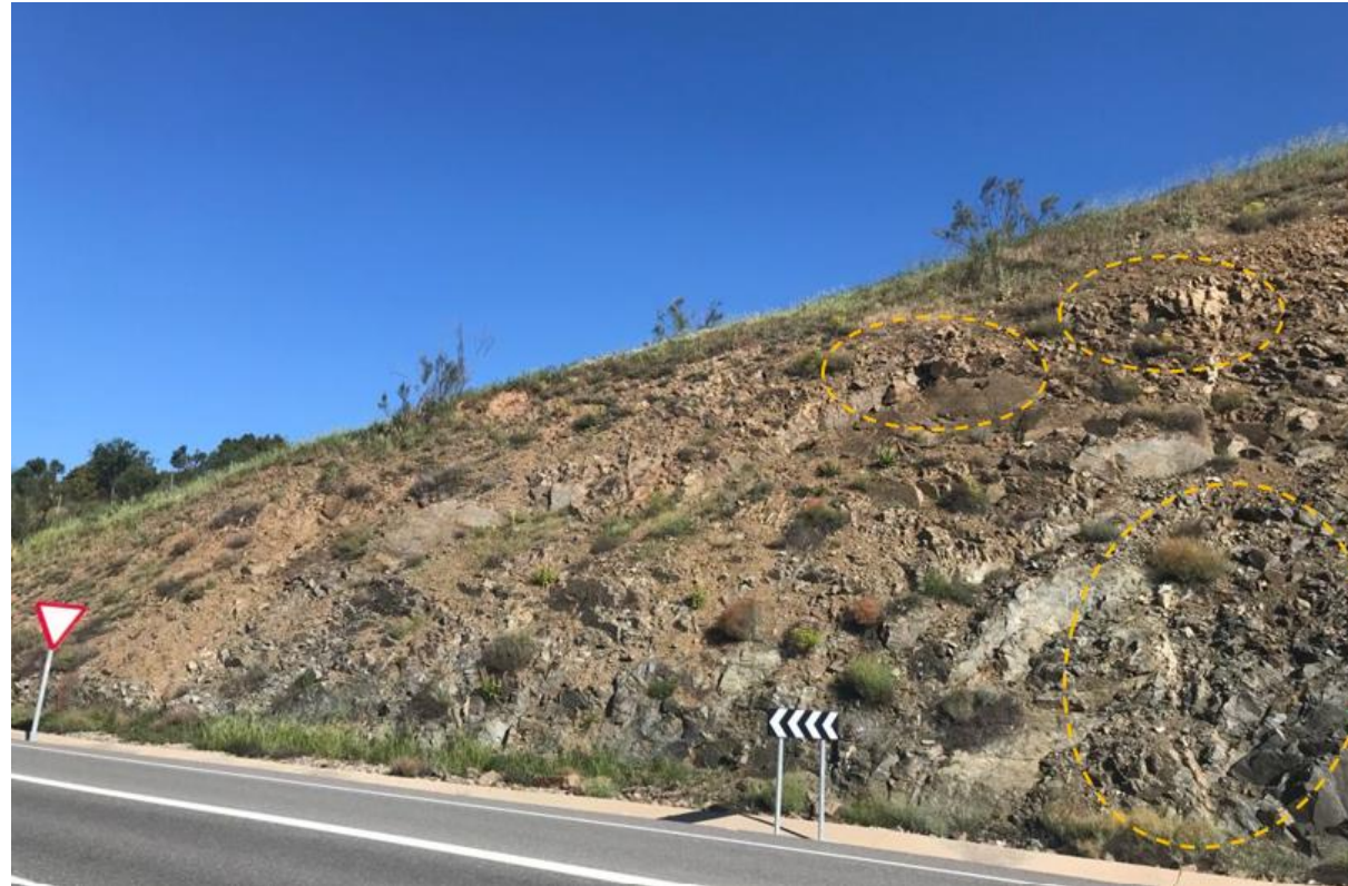
Figura 1 – Meteorización en superficie. Bloques de caída desde zona intermedia de talud. Fuente: Propia.
