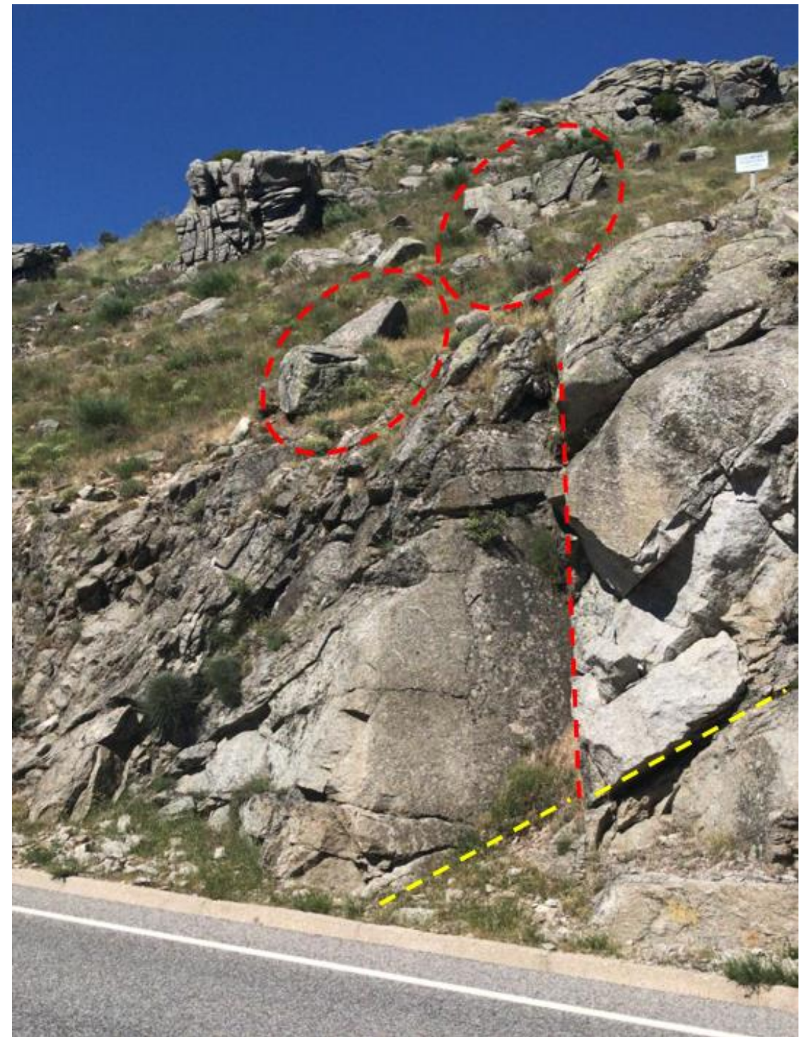
Figura 32 – Familia de discontinuidades que favorecen caída de bloques a vía. Bloques inestables en parte superior del talud. Fuente: Propia.
