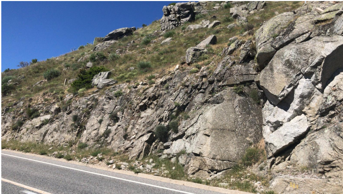
Figura 27 - Bloques desprendidos y bloques en cabeza de talud. Fuente: Elaboración propia.
