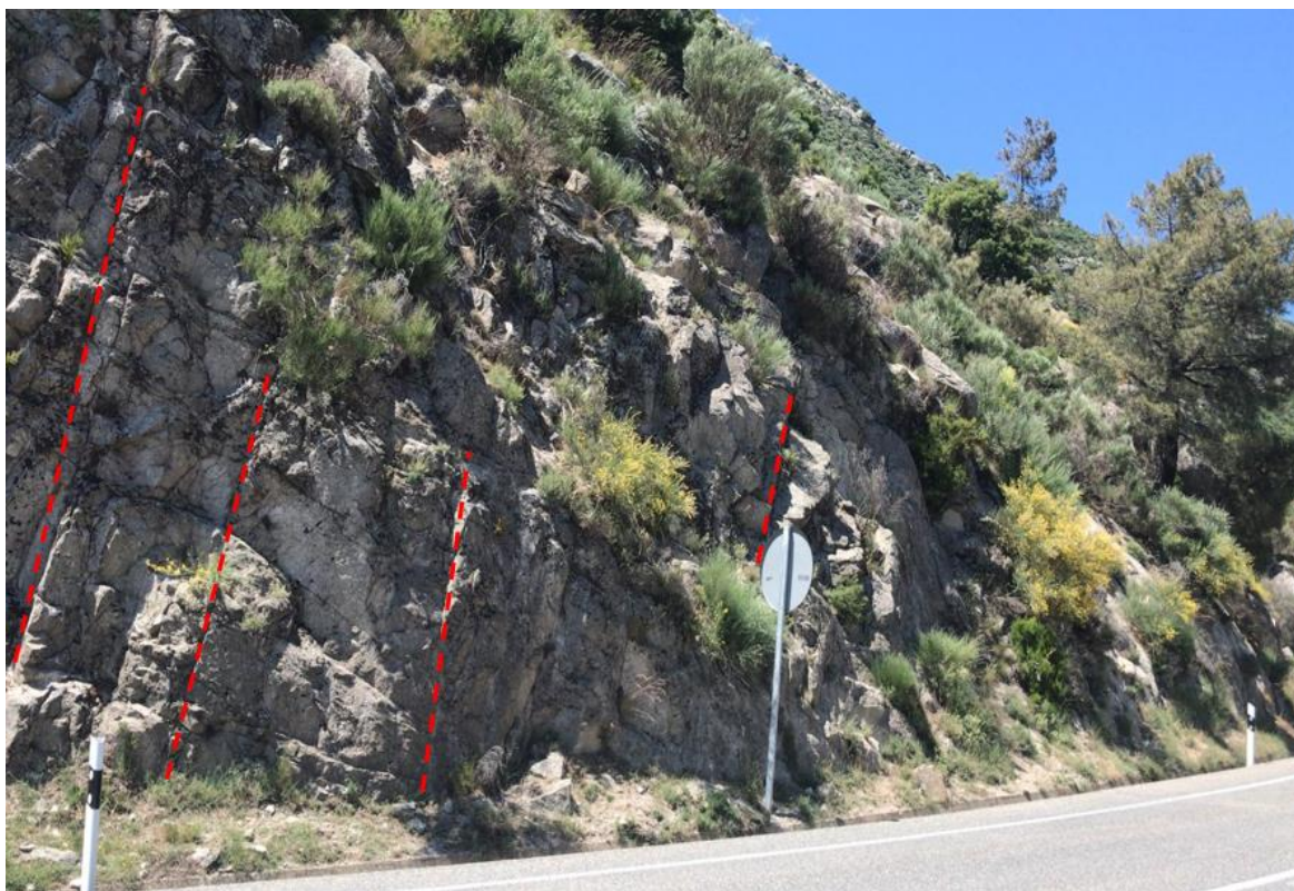
Figura 36 – Discontinuidades en talud. Fuente: Propia.
