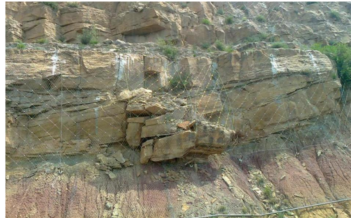
Figura 7 - Redes de cable de acero o sistema Netprotect. Fuente: Paramassi.
