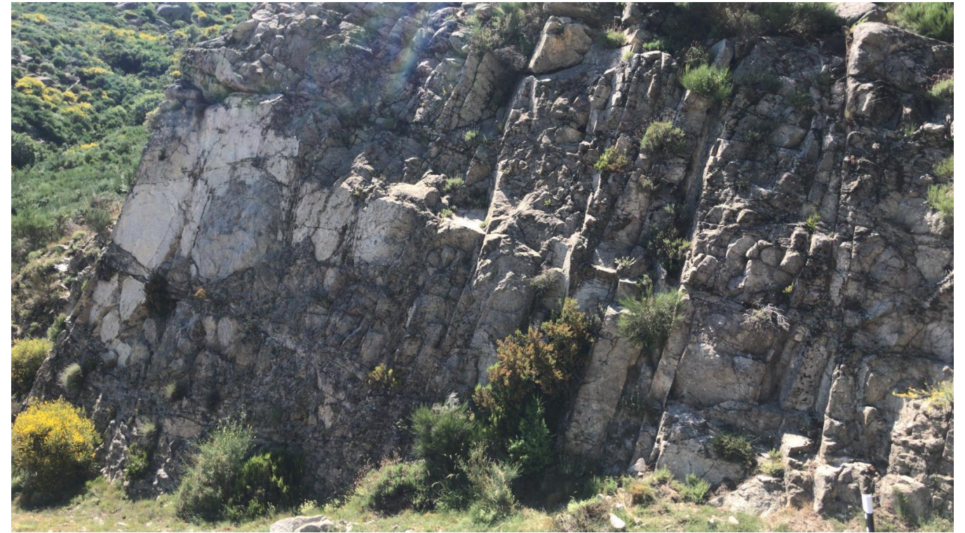
Figura 29 - Detalle meteorización en talud 11. Fuente: Elaboración propia.
