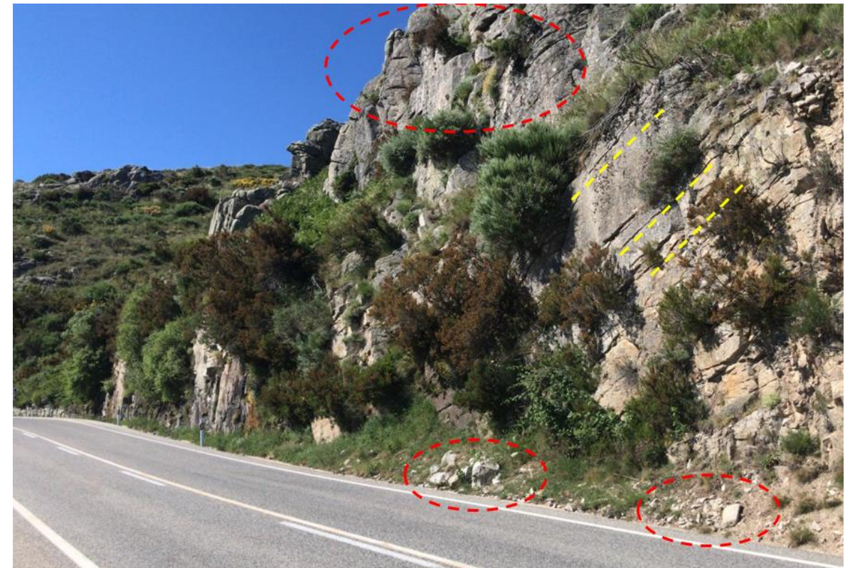
Figura 27 – Bloques en pie de talud. Bloques inestables en cabeza de talud. Familia de discontinuidades en talud. Fuente: Propia.
