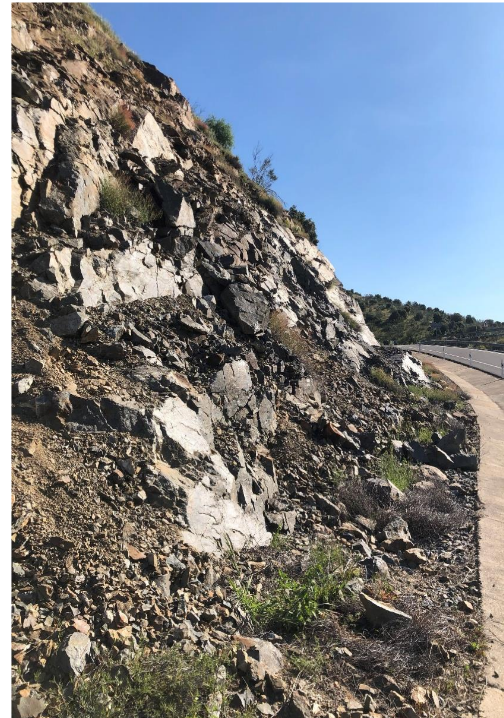
Figura 4 - Acumulación de desprendimientos en pie de talud. Fuente: Elaboración propia.
