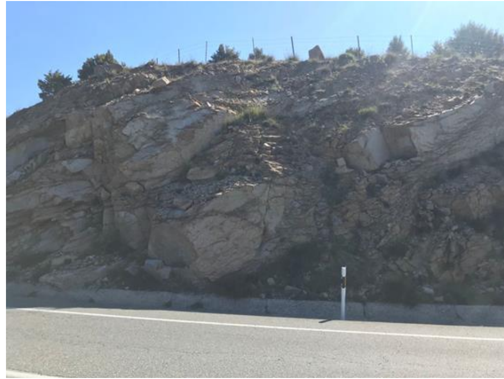
Figura 18 - Meteorización generalizada en talud 6. Fuente: Elaboración propia.
