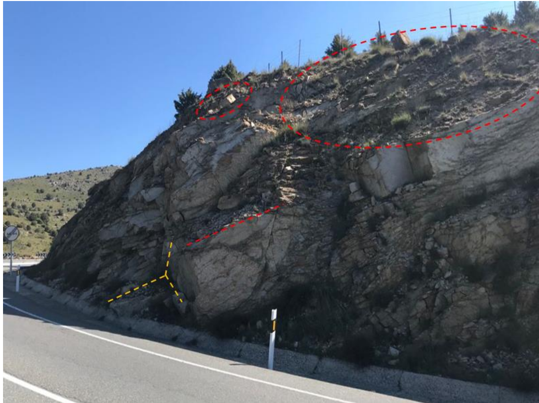
Figura 15 – Talud en curva a derechas. Bloques inestables en cabeza de talud. Favorable deslizamiento de la estratificación a vía. Acumulación de tierra vegetal en cabeza de talud. Fuente: Propia.
