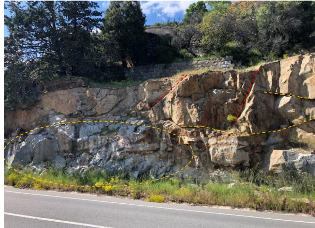
Figura 6 – Masa rocosa de irregularidades en parte inferior del talud. Planos de deslizamiento planares. Familias de discontinuidades semihorizontales. Fuente: Propia.
