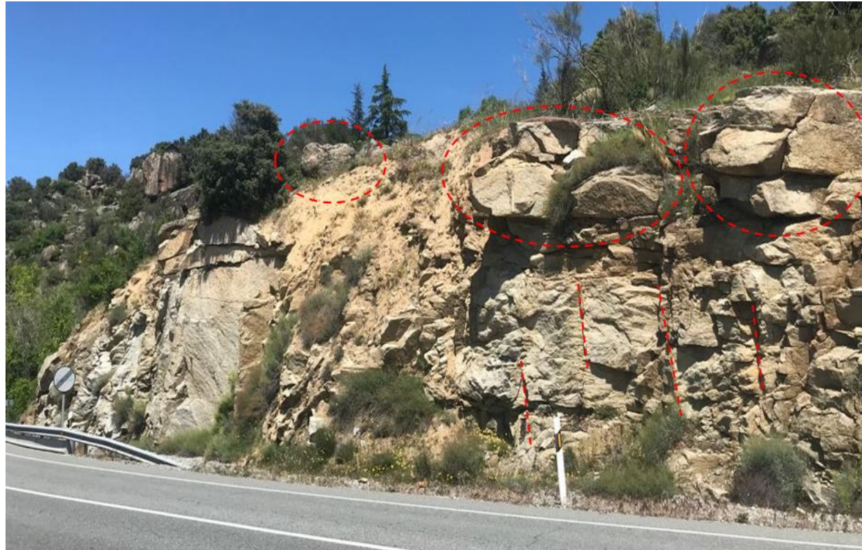
Figura 12 – Masas rocosas en cabeza de talud. Bloque inestable en cabeza de talud. Familia de discontinuidades principal en talud. Fuente: Propia.
