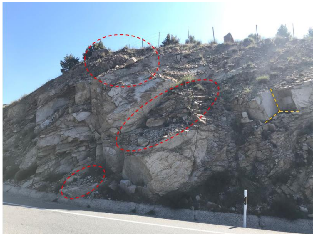
Figura 16 – Bloques inestables en cabeza de talud. Meteorización en toda su superficie y presencia de pequeños fragmentos en pie de talud. Fuente: Propia.
