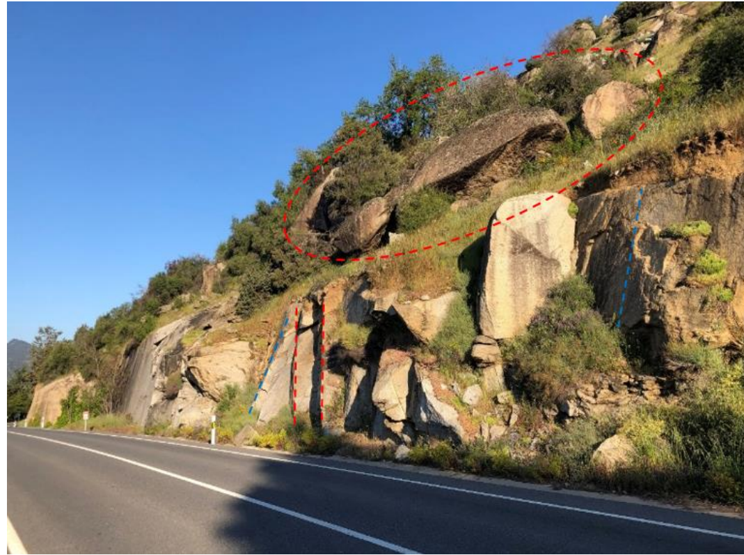
Figura 7 – Bolos de gran tamaño en cabeza de talud. Familias de discontinuidades semiverticales. Fuente: Propia.
