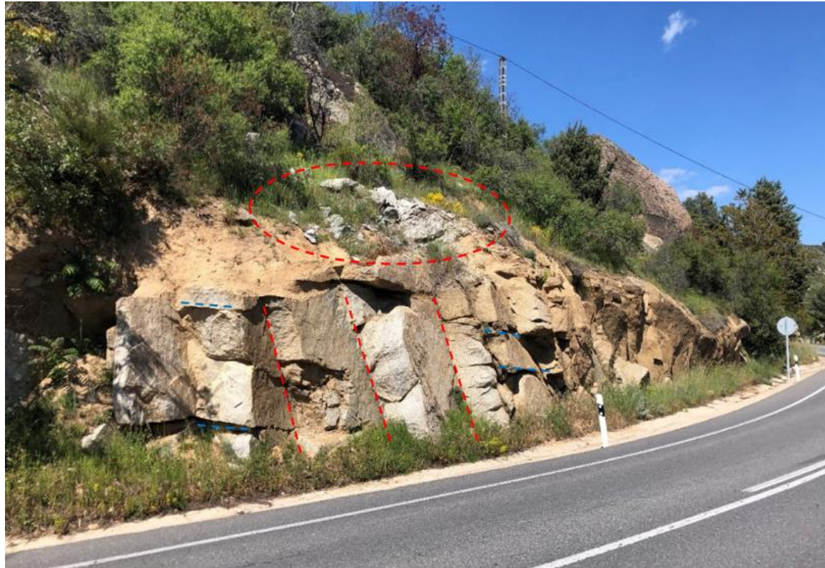
Figura 10 – Planos de rotura prácticamente verticales. Planos de rotura semihorizontales. Bloques inestables en cabeza de talud. Fuente: Propia.
