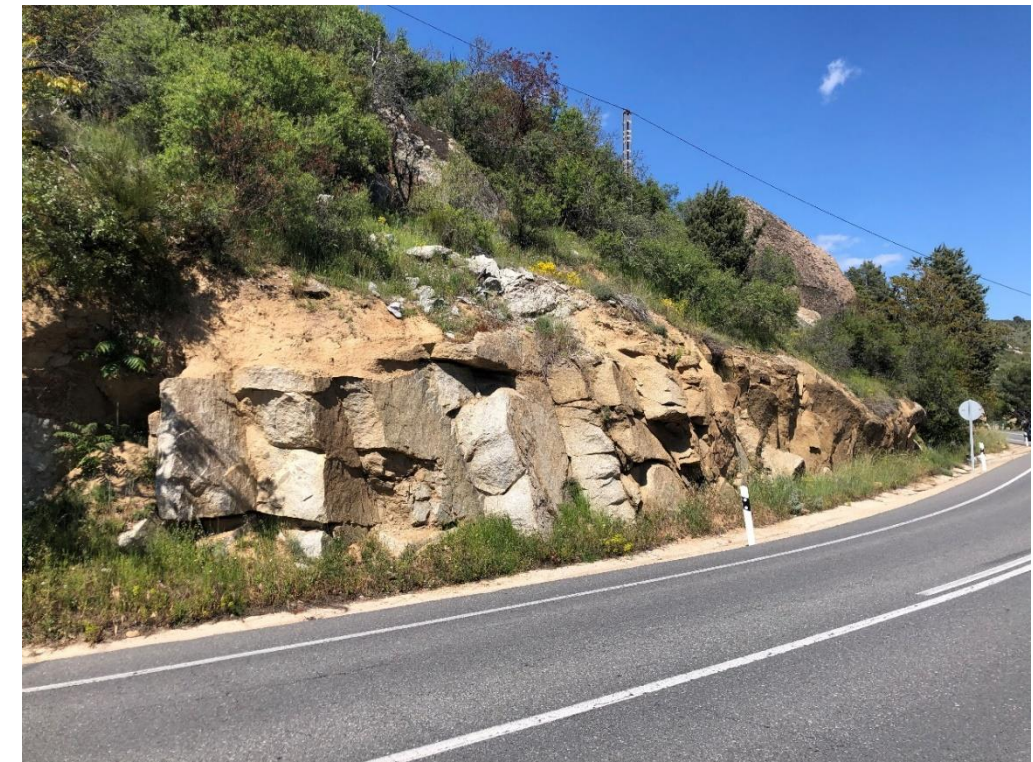
Figura 11 - Estratificación en talud 4. Fuente: Elaboración propia.
