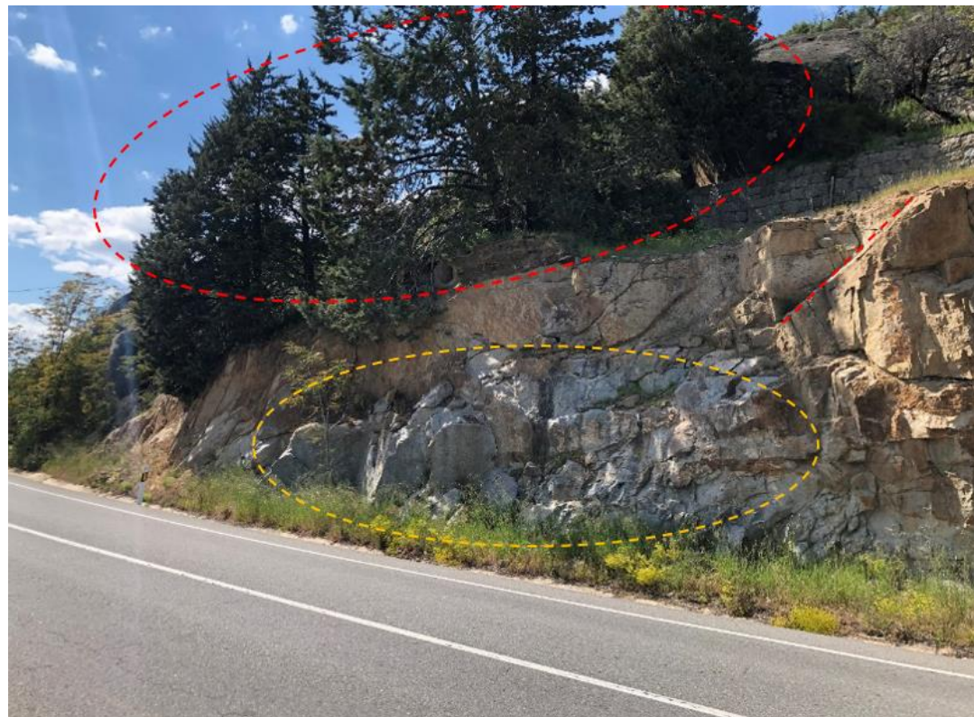
Figura 5 – Plano de rotura aleatorio. Árboles en cabeza de talud. Zona de gran masa rocosa en la parte inferior del talud. Fuente: Propia.
