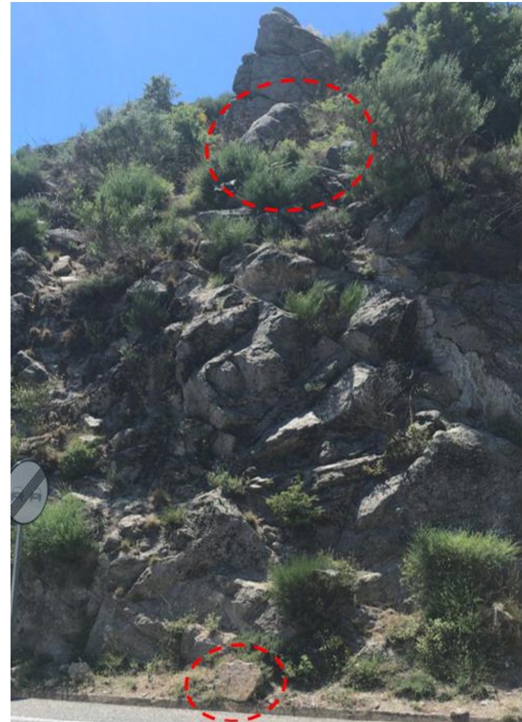
Figura 34 – Bloques en cabeza y en pie de talud. Ausencia de cuneta. Fuente: Propia.
