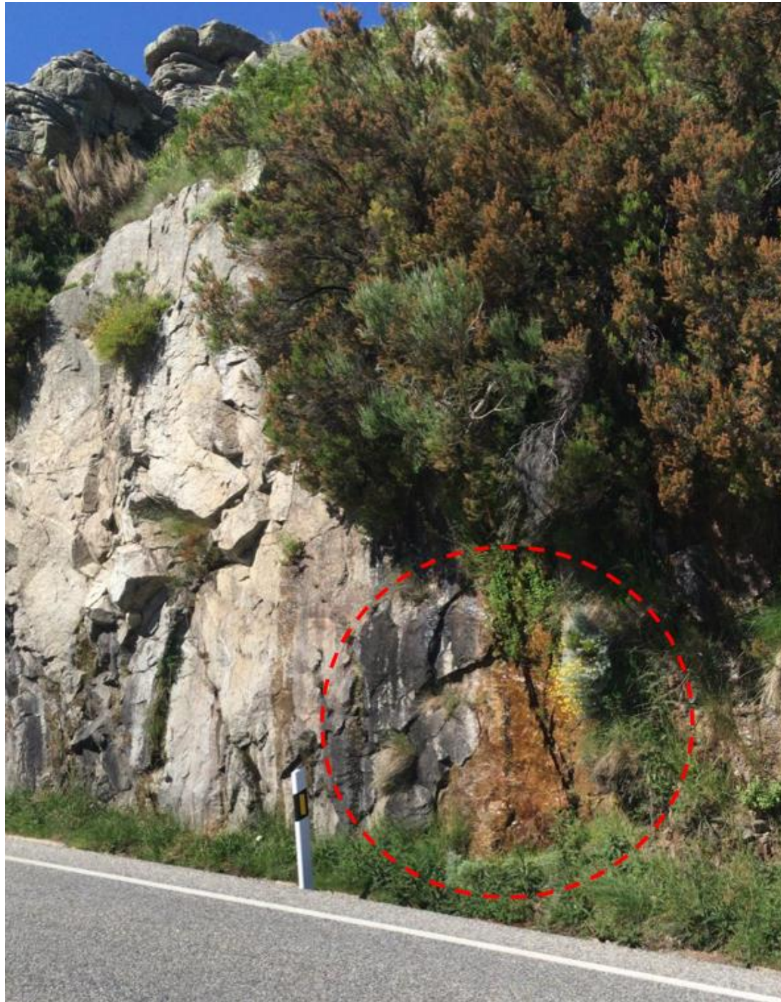
Figura 26 – Zona de goteo de agua. Fuente: Propia.
