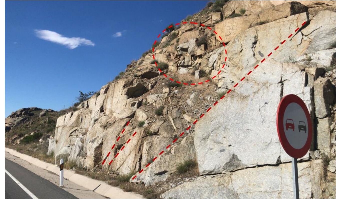
Figura 20 – Plano de rotura planar. Bloques inestables en zona central. Detalle de cuneta. Fuente: Propia.
