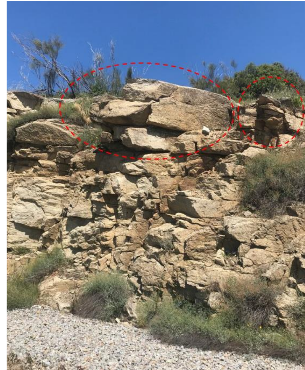
Figura 14 – Detalle de familias de discontinuidades y bloque en cabeza de talud. Berma en pie de talud. Fuente: Propia.
