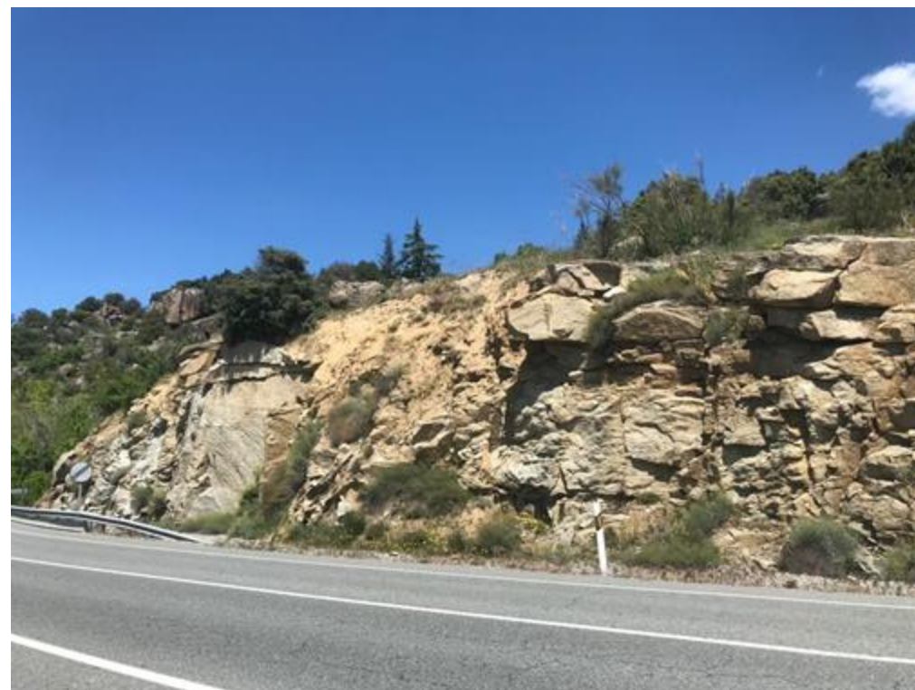
Figura 14 - Detalle meteorización generalizada en talud. Fuente: Elaboración propia.
