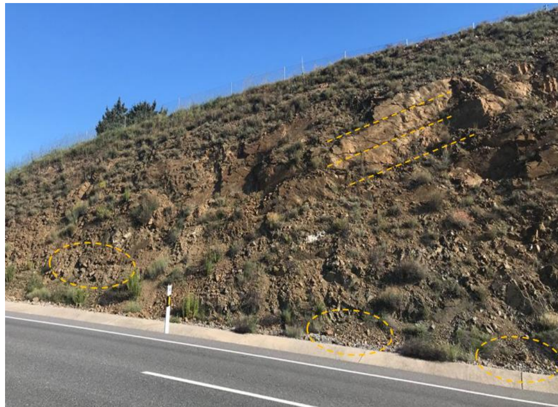
Figura 2 – Estratificación del talud. Meteorización y chineo
