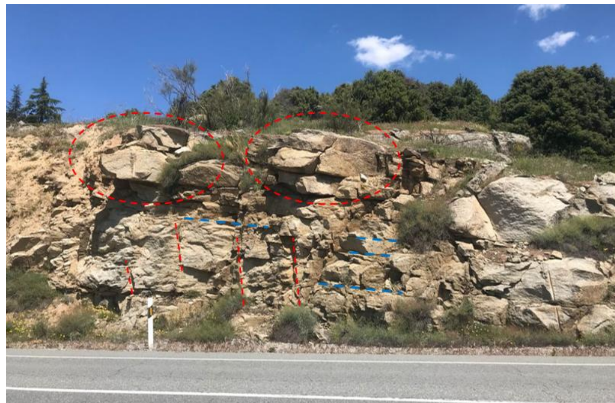
Figura 13 – Masas rocosas en cabeza de talud. Familias de discontinuidades principales. Fuente: Propia.
