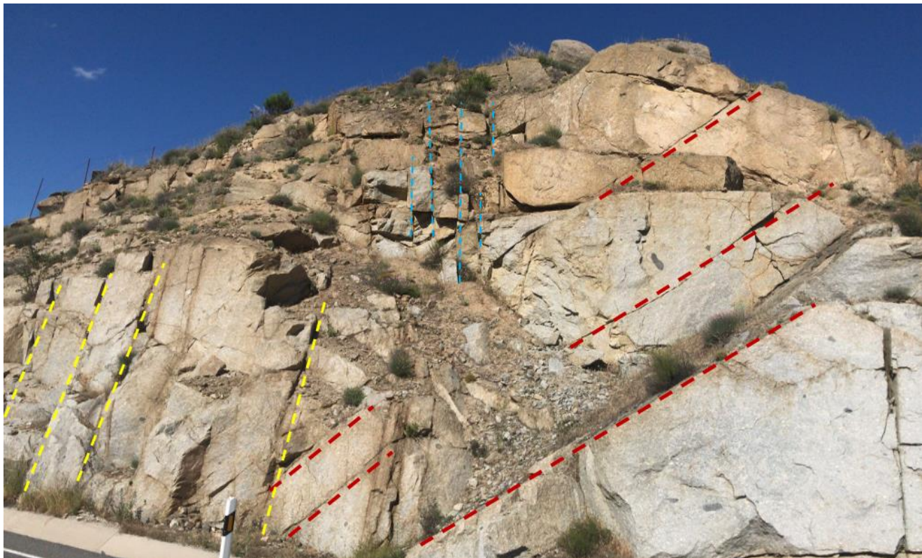
Figura 19 – Familias de discontinuidades secundaria que favorecen roturas planares. Fuente: Propia.
