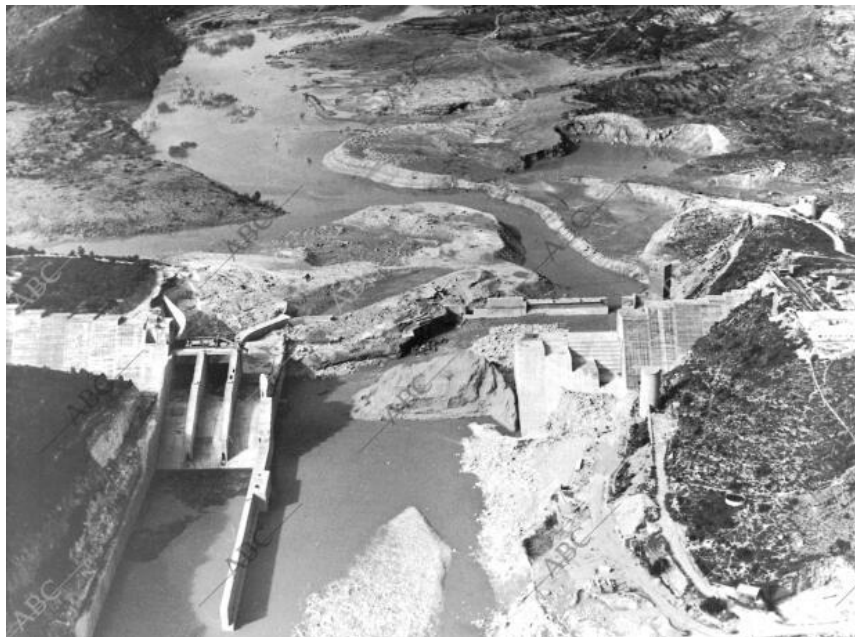
Figura 7. Estado de la antigua presa de Tous tras la rotura. Fuente abc.es
