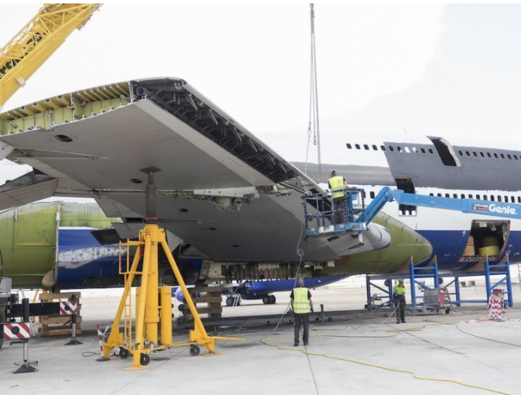
Figura 9. Desmantelamiento de un Boeing 747-400 por la empresa Tarmac Aragón en sus instalaciones en el aeropuerto de Teruel.
