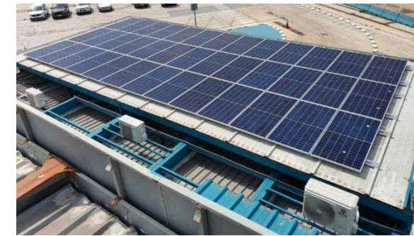
Ilustración 49. Placas solares sobre cubierta de Terminal de Balearia (Valencia). (Fuente:ElMercantil)
