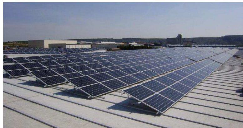
Ilustración 98. Paneles fotovoltaicos sobre cubierta. (Fuente: AlusínSolar)
