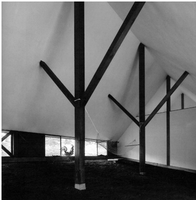
FIG 11. Estructura de madera que soporta la cubierta de la casa Tanikawa (1972), Nagato. Arquitecto: Kazuo Shinohara
