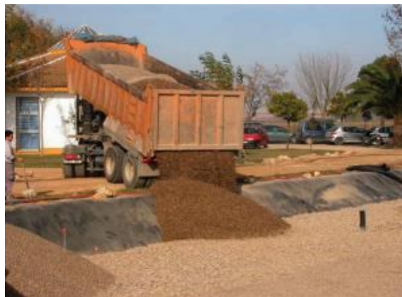
Figura 20. Descarga directa de áridos en el interior de un Humedal Artificial
