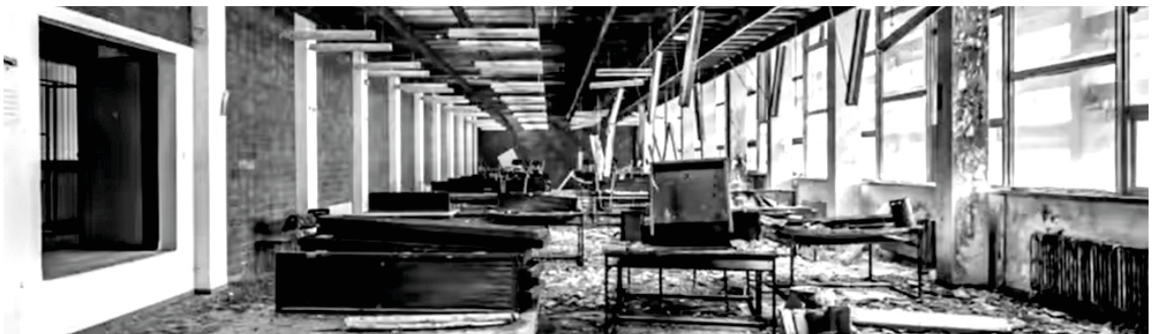
Fig.6. Interior de las aulas, estado de abandono.
