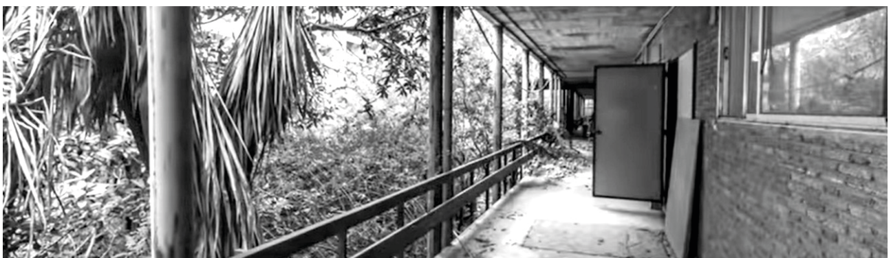
Fig.7. Pasillo exterior en patio longitudinal, estado de abandono.
