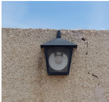
Receptor 8. Luminaria fachada 30W (15 uds)
