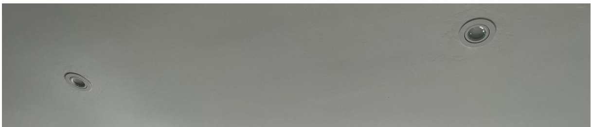
Receptor 6. Luminaria salón 40W (10 uds)
