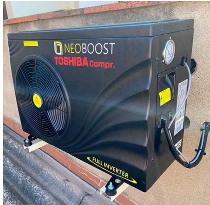
Receptor 10. Bomba climatizadora 1000W
