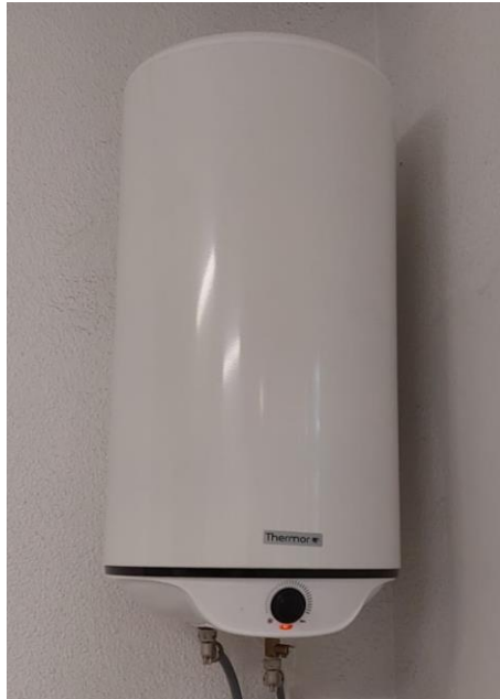
Receptor 7. Termo eléctrico de 100L, 1500W
