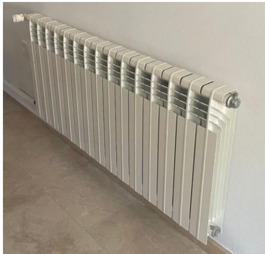
Receptor 4. Sistema de calefacción con radiadores 2000W
