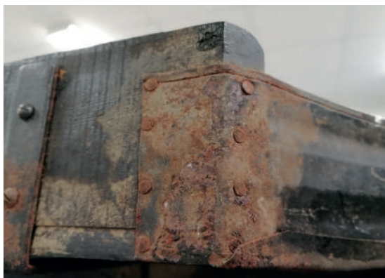
Figura 30. Vista detalle. Productos de corrosión.
