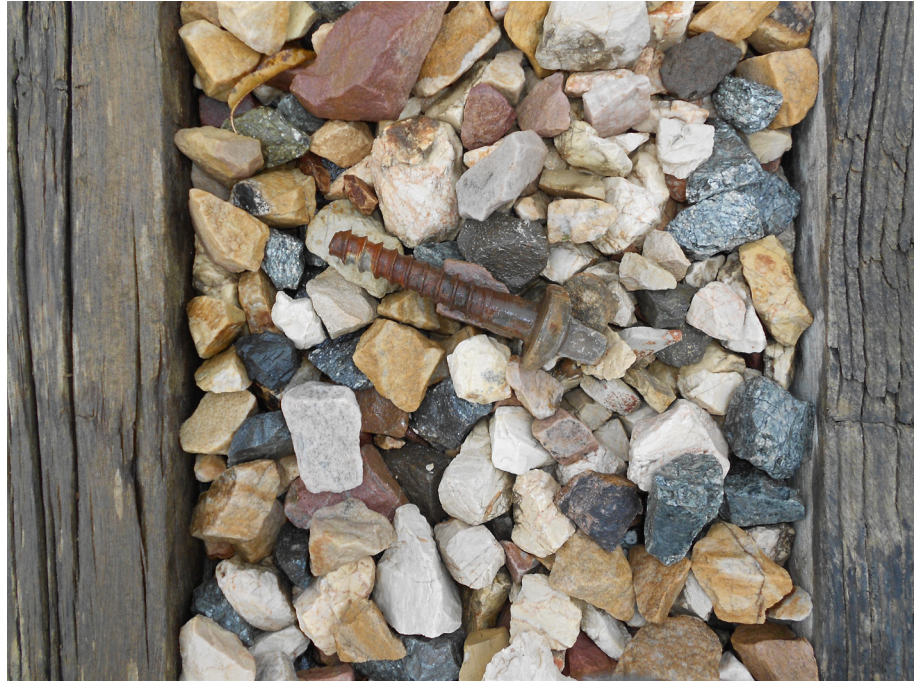
Fig. 17. Tornillo del raíl oxidado.
