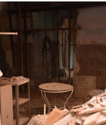
Fig.2: Casa derruida, Carrer dels Àngels, Cabanyal.
