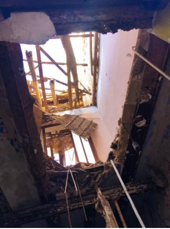
Fig.3: Casa derruida, Carrer dels Àngels, Cabanyal.
