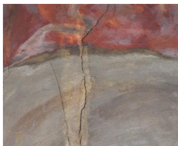
Fig. 21. Detalles de las grietas.
