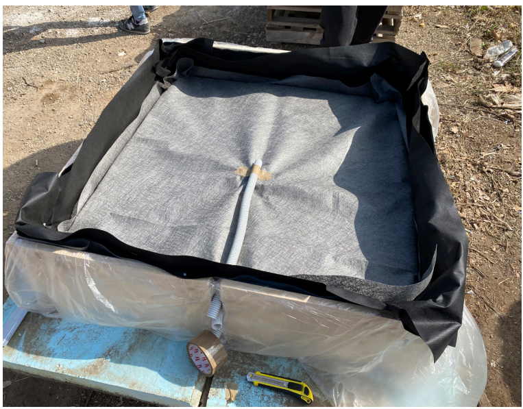
Figura 6.26. Conducto de tubo corrugado para sonda exterior del data-logger B3, sobre lámina filtrante.
