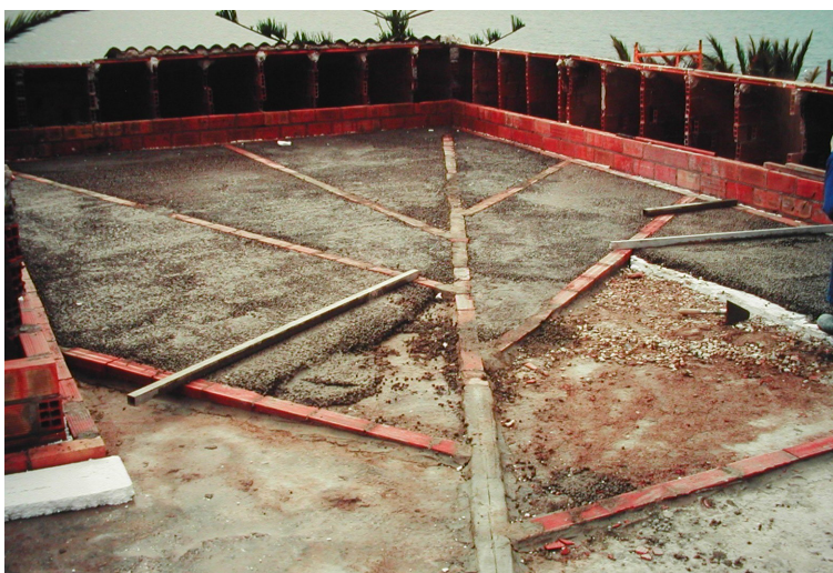
Figura 4.3. Relleno de los paños de la cubierta con el material de formación de pendientes.
