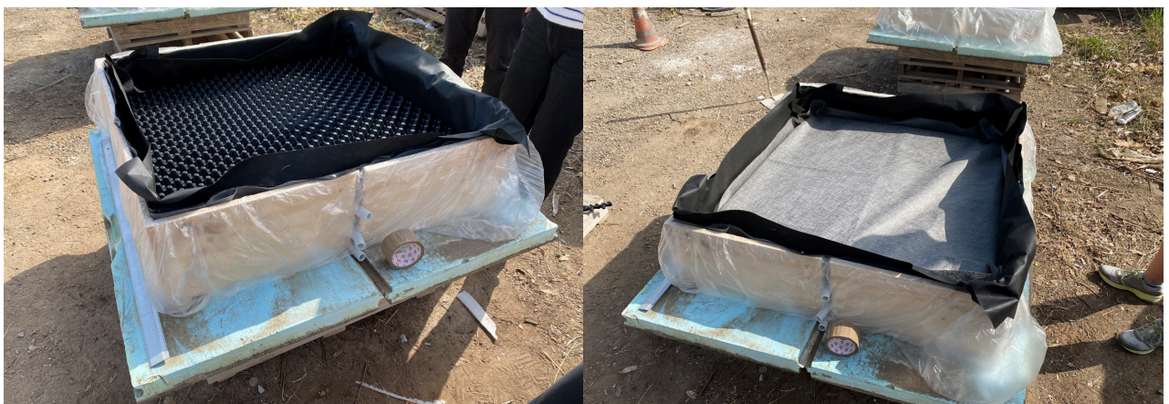
Figura 6.21. Colocación de capa drenante de paneles nodulares (izq.) y lámina filtrante (dcha.) en el modelo B.
