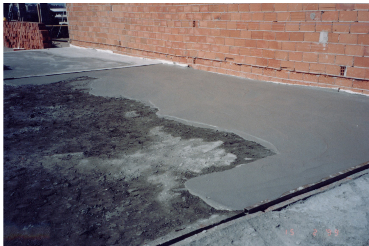
Figura 4.5. Capa de mortero de regularización para aportar planeidad a la superficie de acabado.
