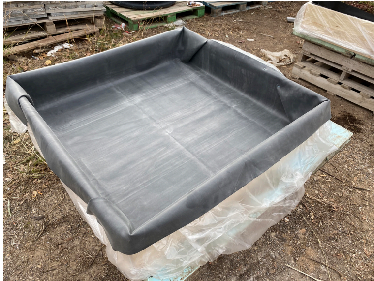
Figura 6.19. Colocación de la lámina impermeable EPDM, sistema no adherido, en el modelo A.
