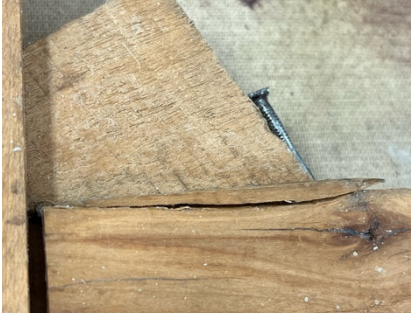
Fig. 37. Rotura parcial de la madera.
