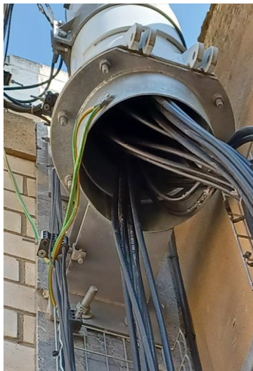
Figura 29. Cableado de las antenas
