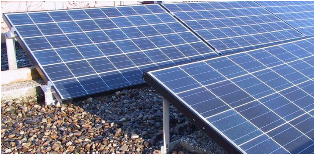
Imagen 2.7. Sombras parciales en instalación de placas solares. [19]
