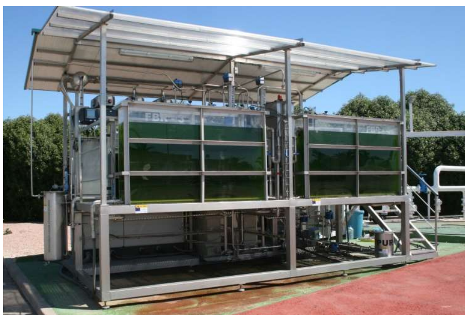
Figura 3.1. Vista general de la planta MPBR.
