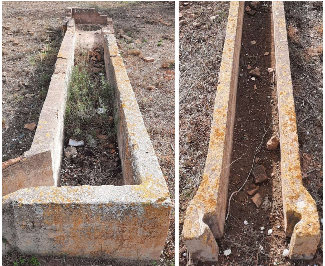
Figuras 29 y 30 : Canalizaciones exteriores de la Masía de la Almunia. Elaboración propia.
