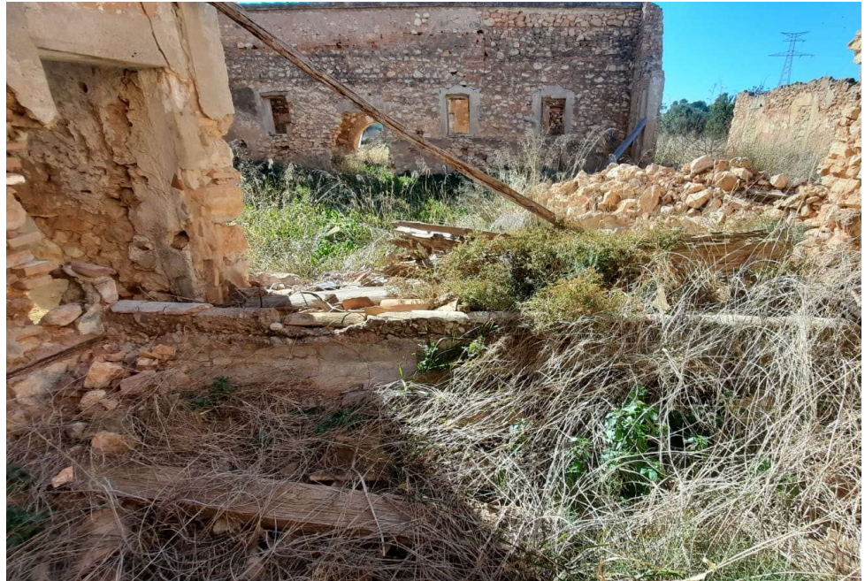
Figura 13: Imagen interior de la Masía de la Almunia donde se aprecia el mal estado de conservación. Elaboración propia.
