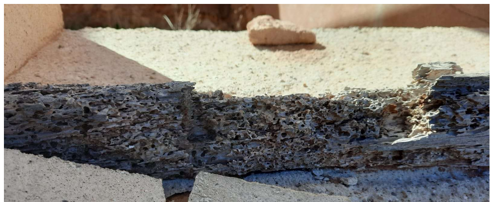
Figura 66: Detalle del deterioro de la carpintería de madera. Elaboración propia.
