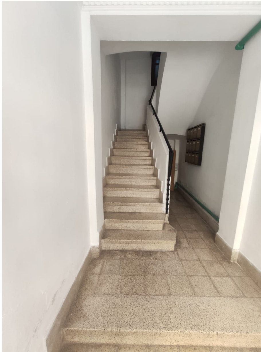
Accesibilidad. Existencia de desnivel [Ref. AC001]
