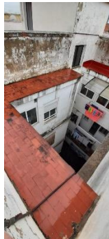
Imagen 18. Moho, suciedad y desprendimiento del material de cobertura. (Imagen propia, 2023).
