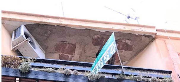
Imagen 16. Desprendimiento del revestimiento y posible corrosión de armaduras. (Imagen propia, 2023).
