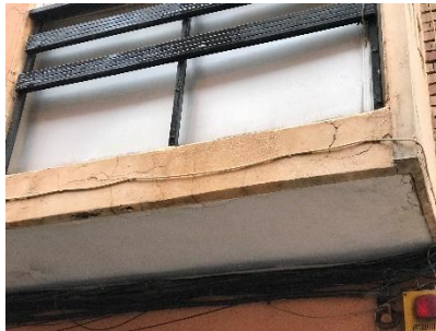
Imagen 12. Grietas y fisuras en frente de voladizo. (Imagen propia, 2023).
