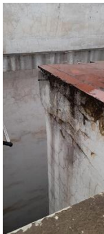
Imagen 14. Fisuras generalizadas en revestimiento exterior. (Imagen propia, 2023).
