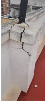
Imagen 13. Grietas generalizadas en pilastra. (Imagen propia, 2023).
