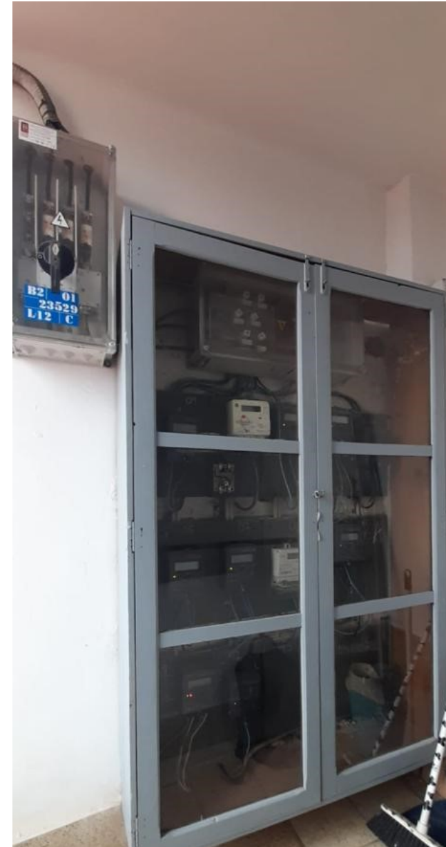
Suministro eléctrico. Contadores. [Ref. IN002]
