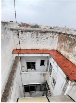
Imagen 15. Fisuras en forma de mapa y desprendimiento en antepechos. (Imagen propia, 2023).
