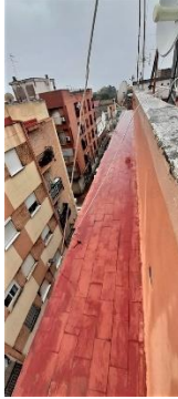
Imagen 17. Desprendimiento material de cobertura. (Imagen propia, 2023).
