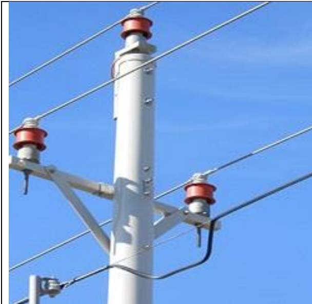
Figura 13. Ejemplo de un poste de fibra de vidrio.
