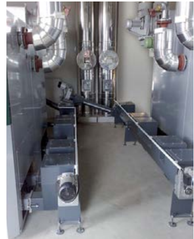
En esta imagen pueden observarse los depósitos de cenizas conectados mediante el sistema sinfín, una solución de 2 calderas en cascada HERZ.
