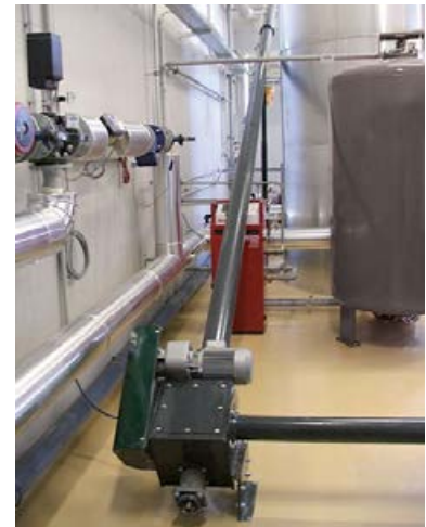
Ejemplo de sinfín que transporta en vertical (aprox. 4 m) las cenizas que generan 2 equipos HERZ hasta un depósito de cenizas de 2m 3 que se encuentra fuera de la sala de calderas.
