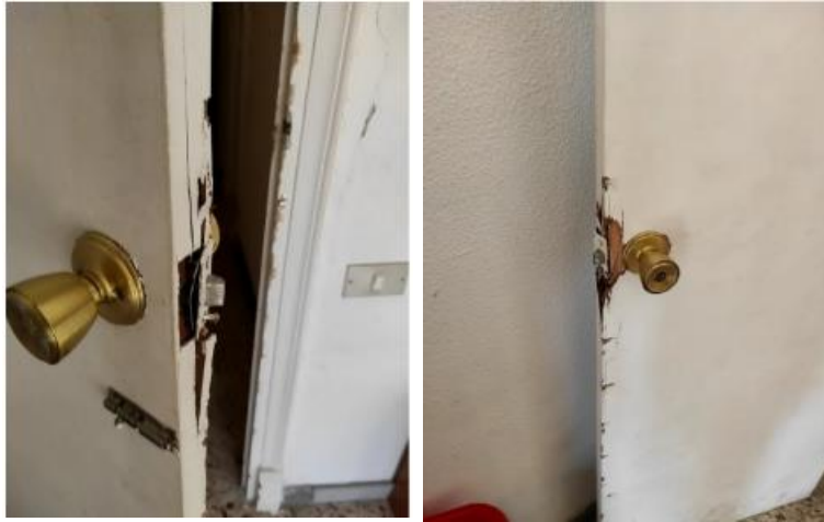
Imagen 32 Rotura de puertas /Fuente propia
