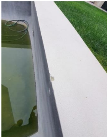
Imagen 34 Rotura de microcemento/Fuente propia
