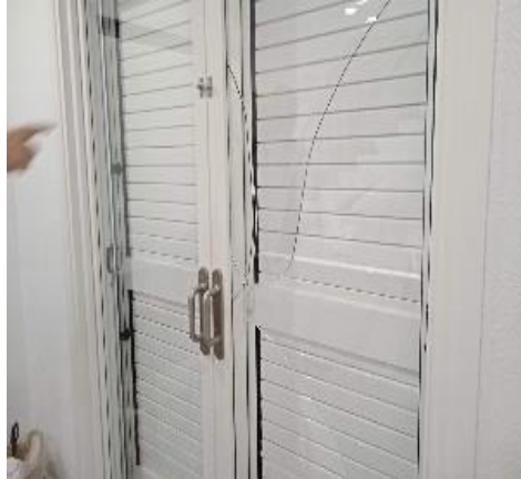
Imagen 31 Rotura de cristal de puerta /Fuente propia
