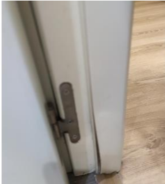
Imagen 40: Daños en marco de la puerta declarados el día 23/02/2023/Fuente propia
