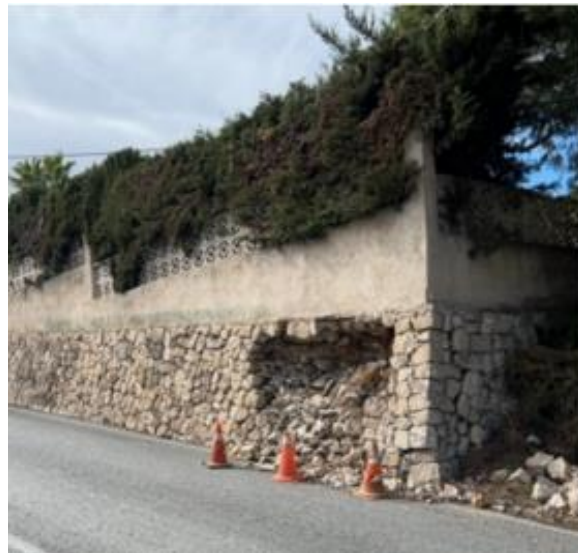
Imagen 28 Impacto en muro perimetral /Fuente propia
