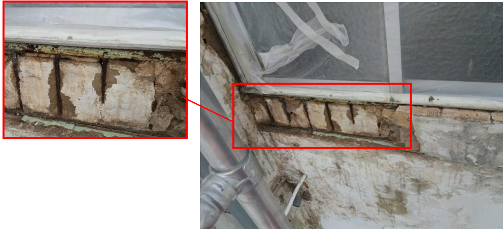
Imagen 16. Fachada en mal estado. Fuente Propia
