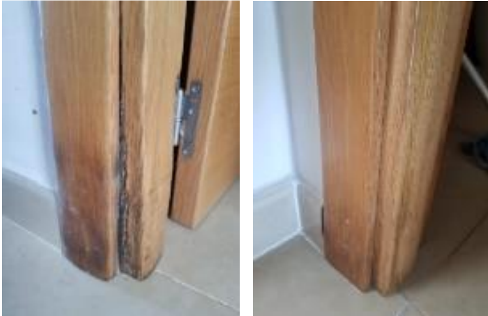
Imagen 4 :daños en marcos / fuente propia
