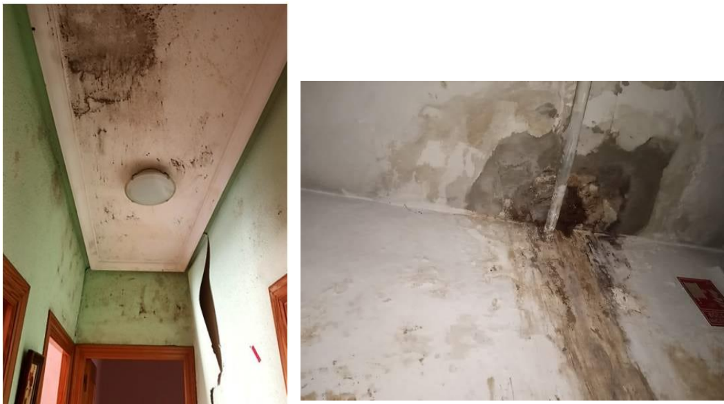
Imagen 13: Deterioro de paramentos /Fuente propia
