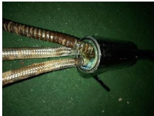
Imagen 8 :Imagen III: Rotura de latiguillos/Fuente propia
