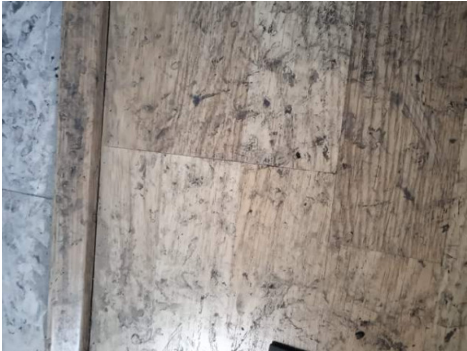
daños en la vivienda (Segunda visita )
