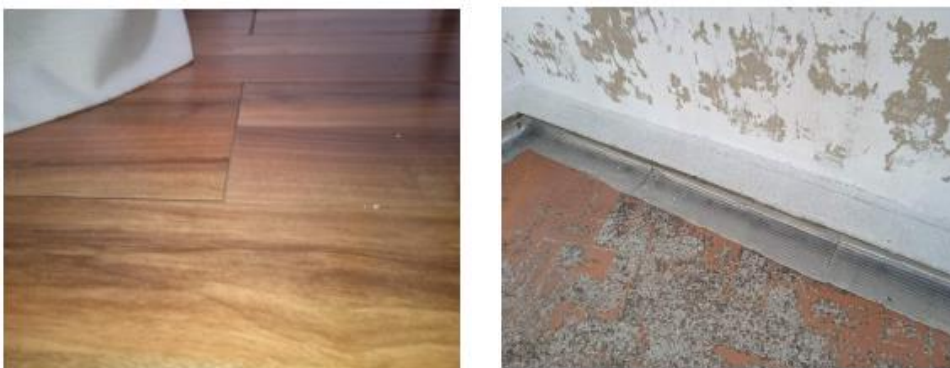
Imagen 17: Cubierta en mal estado /Fuente propia
