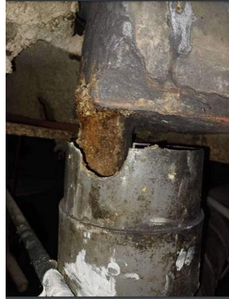
Imagen 7 Rotura de tubería /Fuente propia
