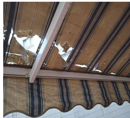
Imagen 20: Rotura de toldo/Fuente propia
