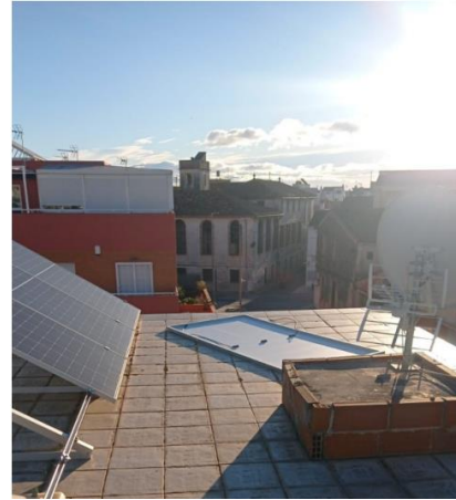
Imagen 21 Desprendimiento de placa solar/Fuente propia
