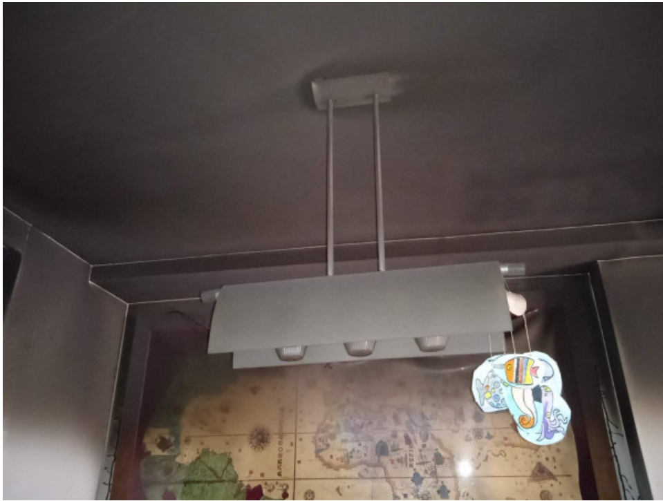
daños en la vivienda (Segunda visita )
