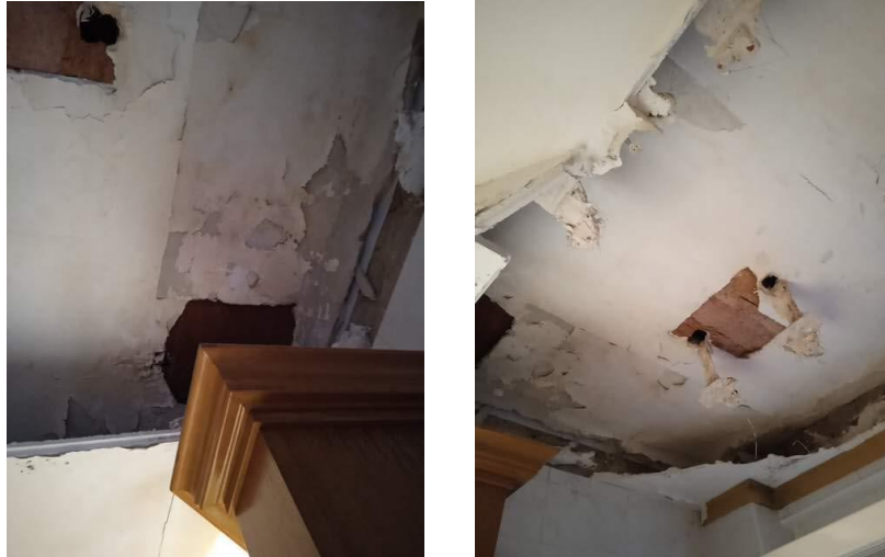
Imagen 11: Desprendimiento de falso techos/Fuente propia
