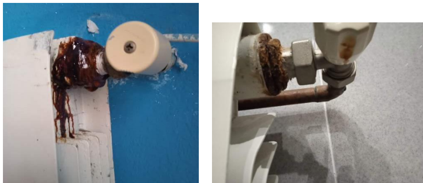
Imagen 12 : Corrosión de tubería /Fuente propia
