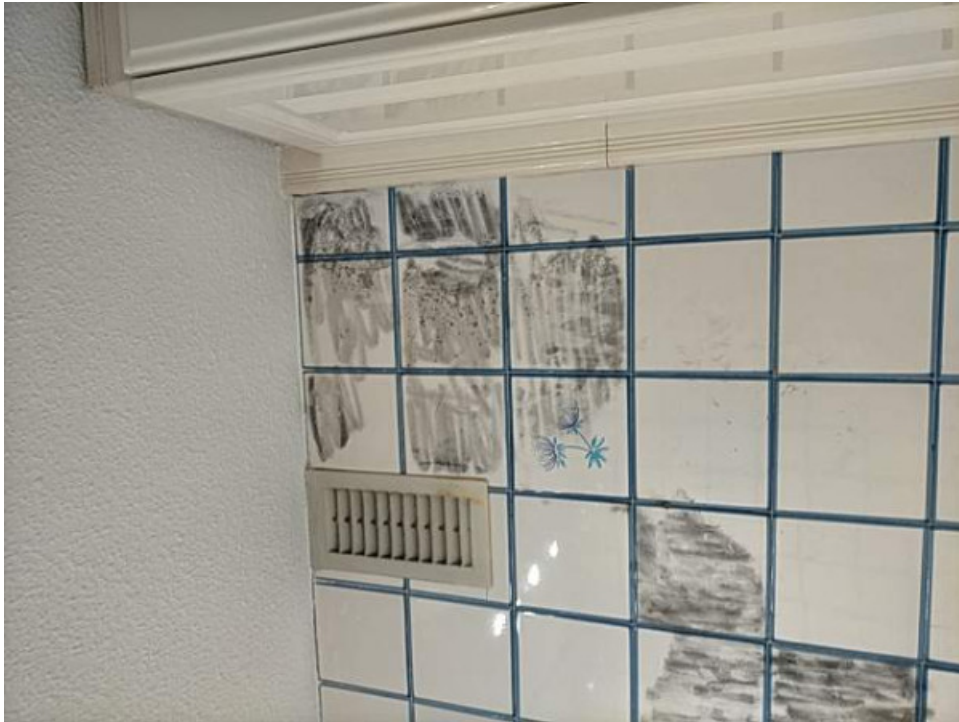
Desperfectos en cisterna
