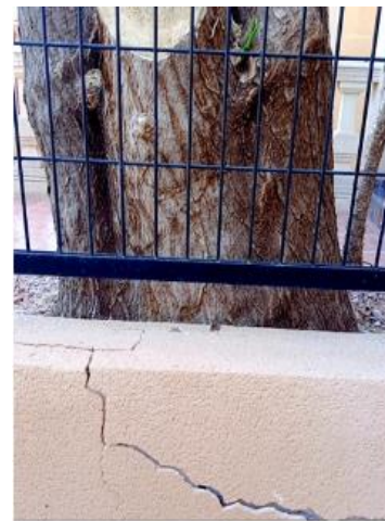
Imagen 35 Rotura de muro medianero /Fuente propia
