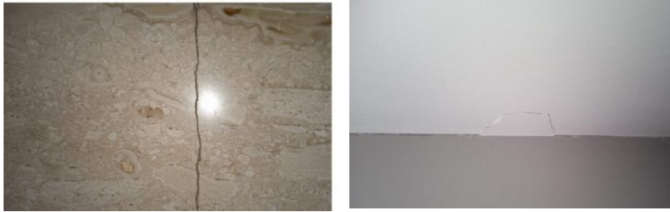
Imagen 26 Grietas en vivienda/Fuente propia
