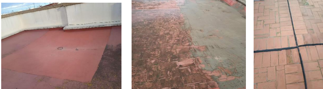
Imagen 18: Reparaciones erróneas de cubierta /Fuente propia
