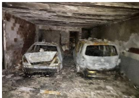
Imagen 24 Incendio en garaje /Fuente propia
