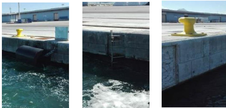
Figura 9 Ilustraciones de defensas, escaleras y bolardos respectivamente Fuente: Puerto de Valencia
