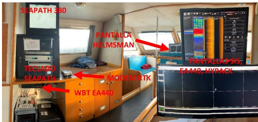
Figura 21 Montaje completo del equipo electrónico para batimetrías Fuente: Propia
