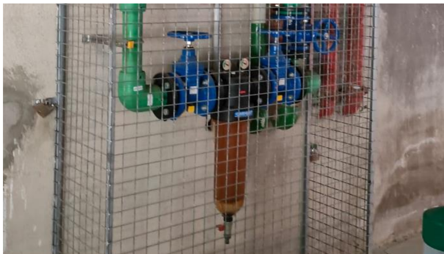
Ilustración 57 Imagen de los Filtros de Agua del Garaje Fuente: Elaboración Propia
