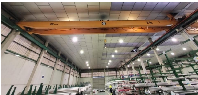
Ilustración 7 - Grúa 1 Inoxcenter - Fuente elaboración propia
