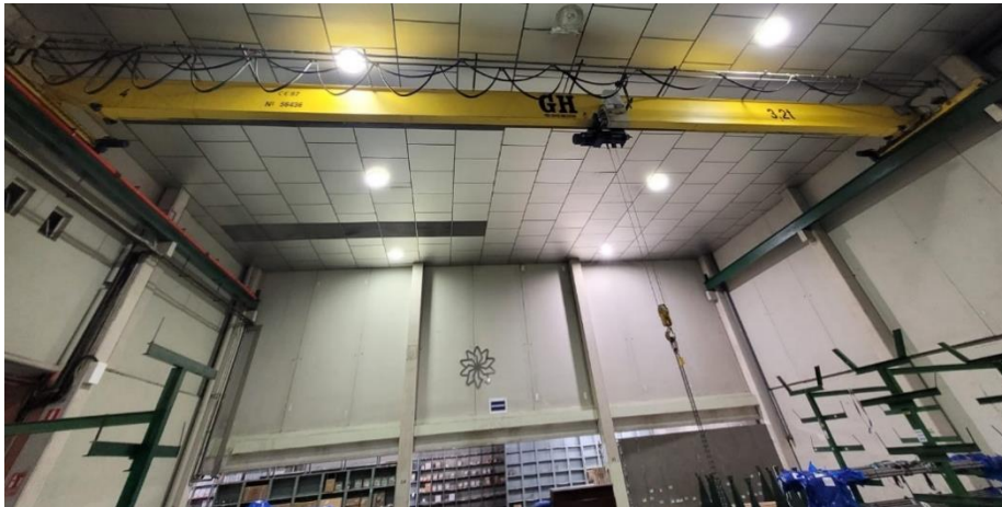
Ilustración 8 - Grúa 2 Inoxcenter - Fuente: elaboración propia
