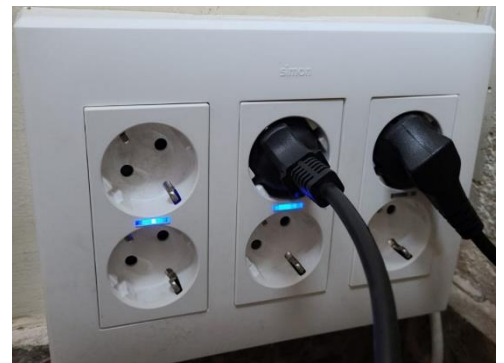
Ilustración 10 - Tomas de corriente Inoxcenter - Fuente: elaboración propia
