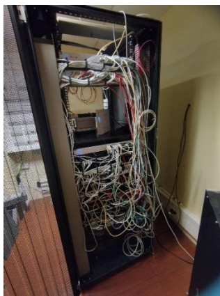
Figura 20. Imagen del armario de la sala de comerciales
