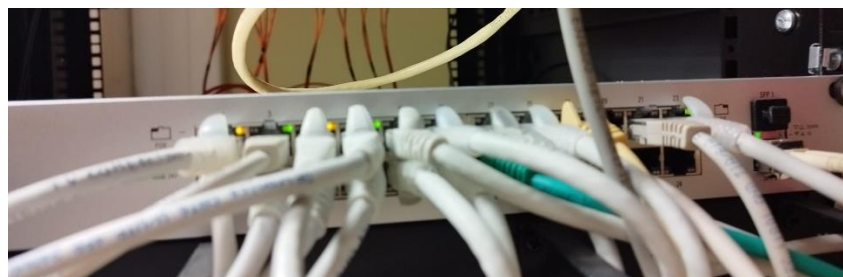
Figura 32. Switch nº1 del armario de comerciales
